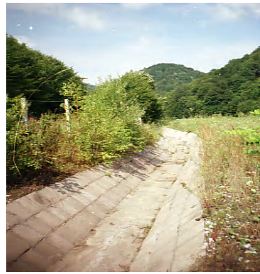
Fig. 6- „Porcu” settling pit
