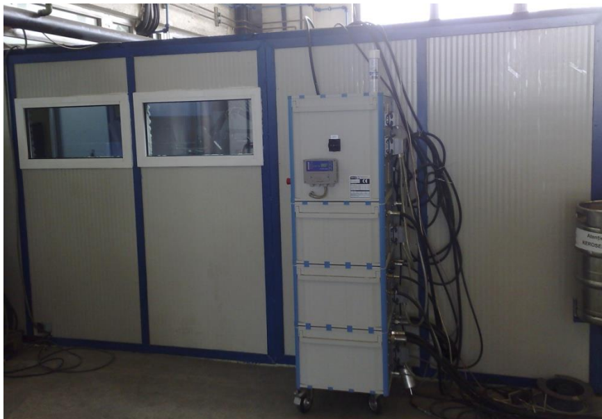
Fig. 2.12. Incinta izolată fonic pentru pulverizare HVOF
