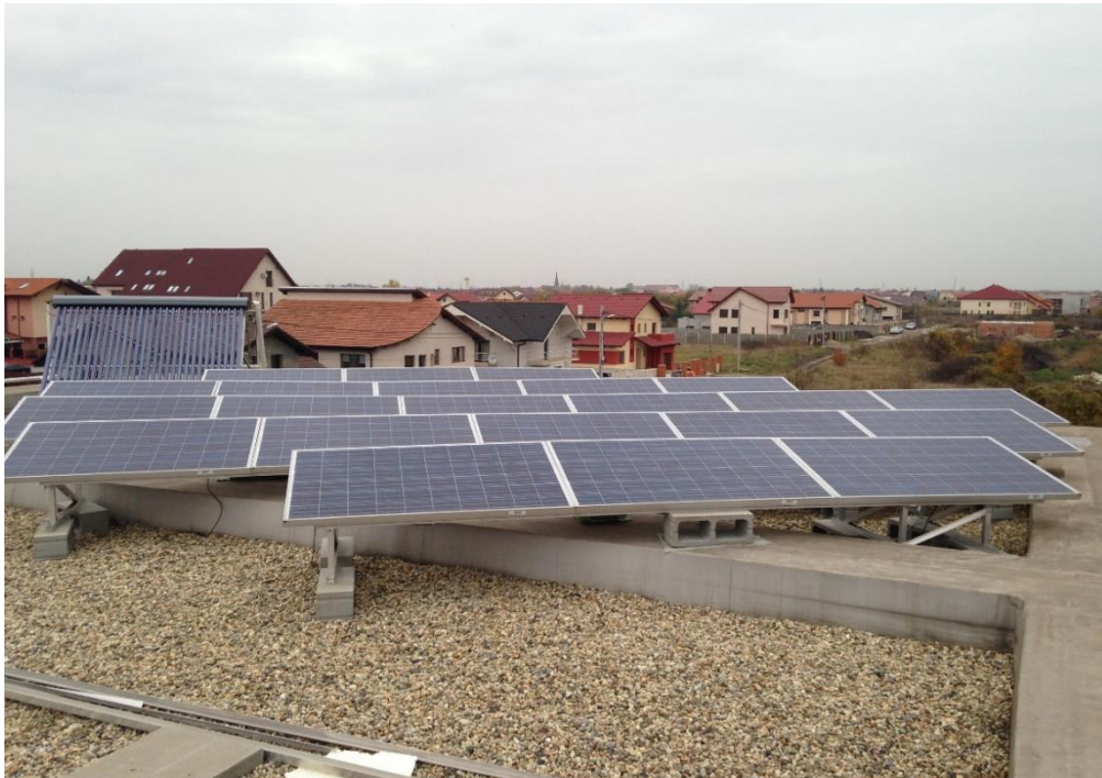
Fig.4.45. Panourile solare fotovoltaice instalate pe acoperiș sursa[28]
