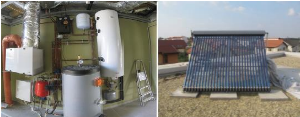
Fig.4.24. Camera tehnică și panoul solar montat pe acoperiș sursa[28]
