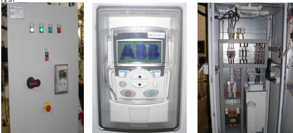
Fig. 1.15 Invertorul ACS850 în laboratorul de pompe: panoul frontal la pornire (stânga), panoului de comandă (mijloc) și interiorul panoului de comandă (dreapta)
