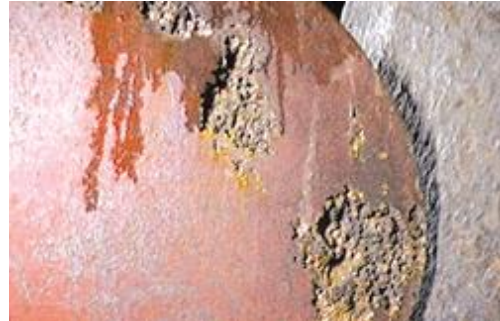
Fig. 1.9 Paleta de rotor Kaplan distrusă prin eroziune cavitațională [172]
