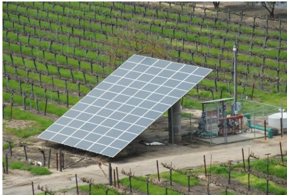
Fig. 3.5. Vedere panou fotovoltaic și generator electric pentru asigurarea pompării apei de irigație la o plantație de viță de vie. [203, 204]
