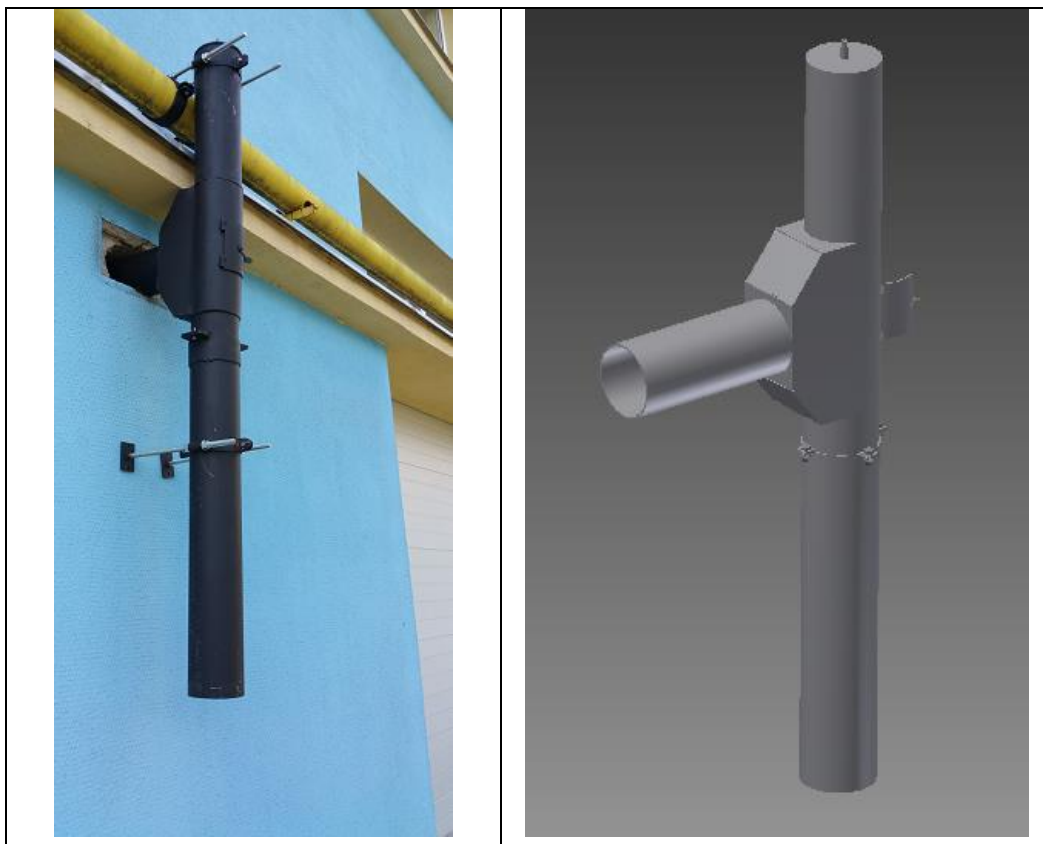
Fig.5.98 Instalație pentru epurarea gazelor
