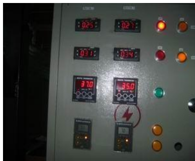
Figura 4.2.1 – Panoul de comandă și monitorizare al instalației[94]
