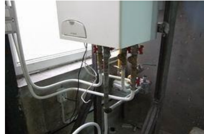
Figura 4.1.3.3. Cazanul folosit pentru încălzirea instalației[94 ]
