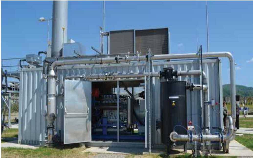
Fig 3.6.1.2. Centrala cogenerare Seini, jud. Maramureș [34]
