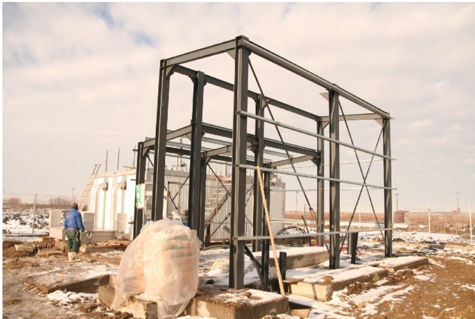
Stația de epurare Ducești Noi - Pavilion tehnologic
