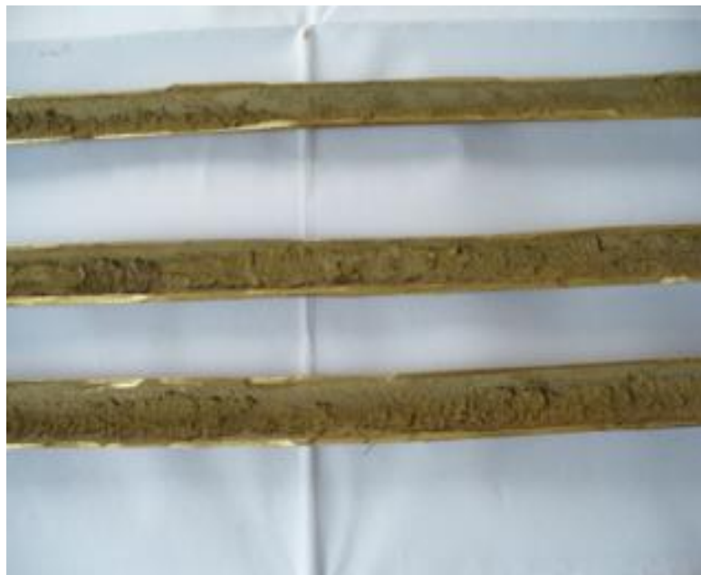
Fig. 2.13. Țevi de condensator cu depuneri la interior.
