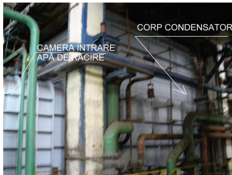
Fig. 2.7. Corpul condensatorului de abur, vedere din exterior.
