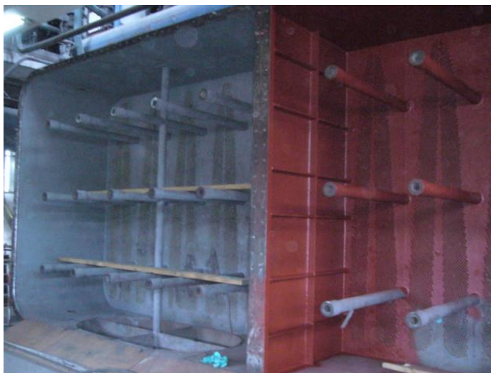
Fig. 2.3. Camerele de intrare apă de răcire ale condensatorului.
