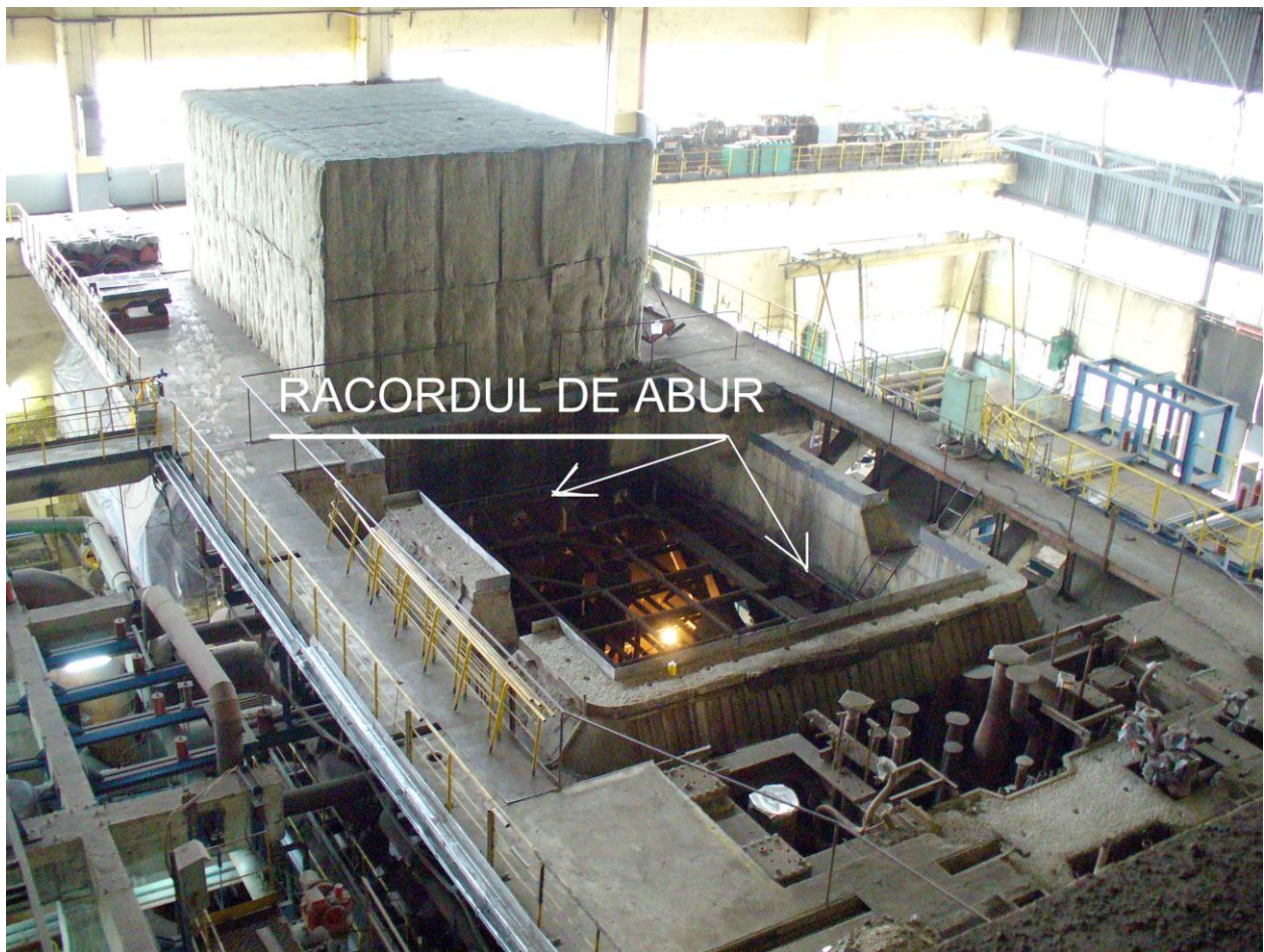
Fig.1.10. Zona de racordare a condensatorului cu turbina de abur.
