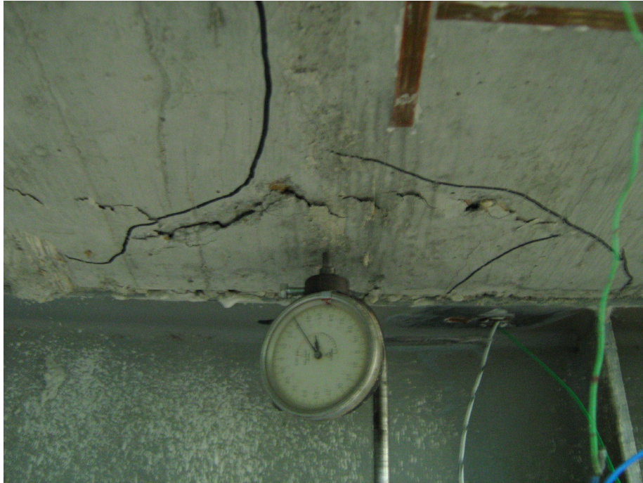
e. desprinderea betonului la partea inferioară
