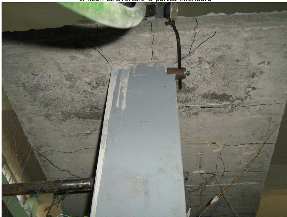
d. fisuri radiale la partea inferioară
