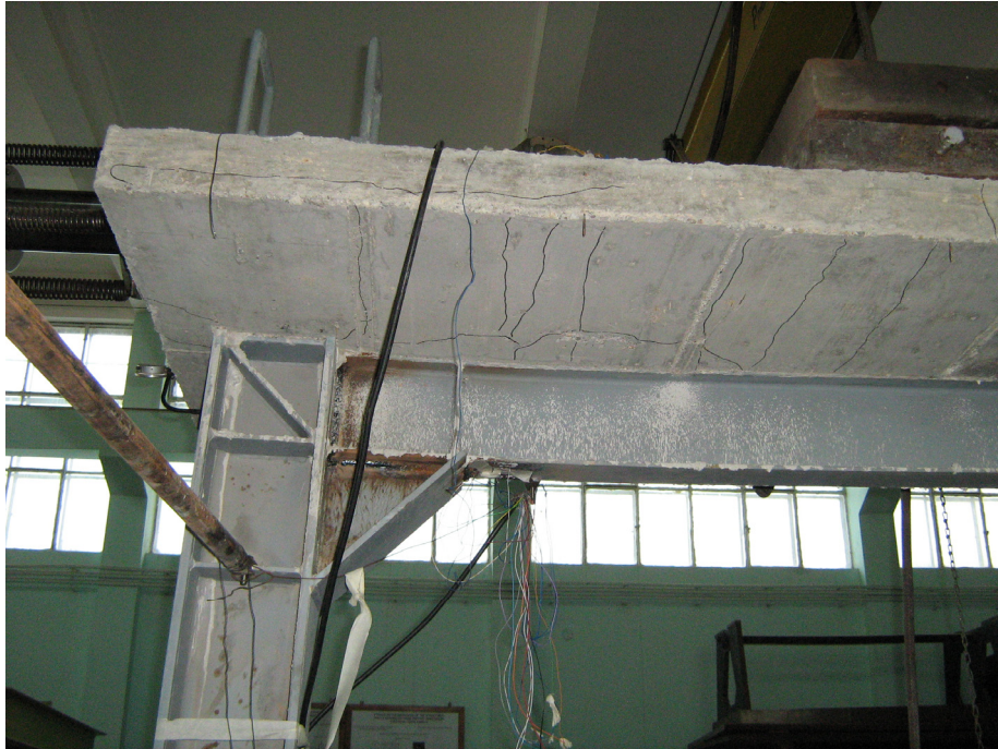
c. fisuri tansversale la partea inferioară
