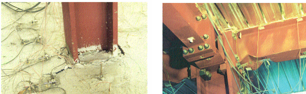
a. Element BR-X: fisurarea și zdrobirea plăcii de beton
