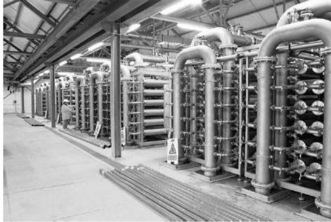
Figura 3.12. Instalația de tratare a apei în scopul potabilizării, echipată cu module de membrane hollow fiber (fibre tubulare) (Keldgate, UK).
