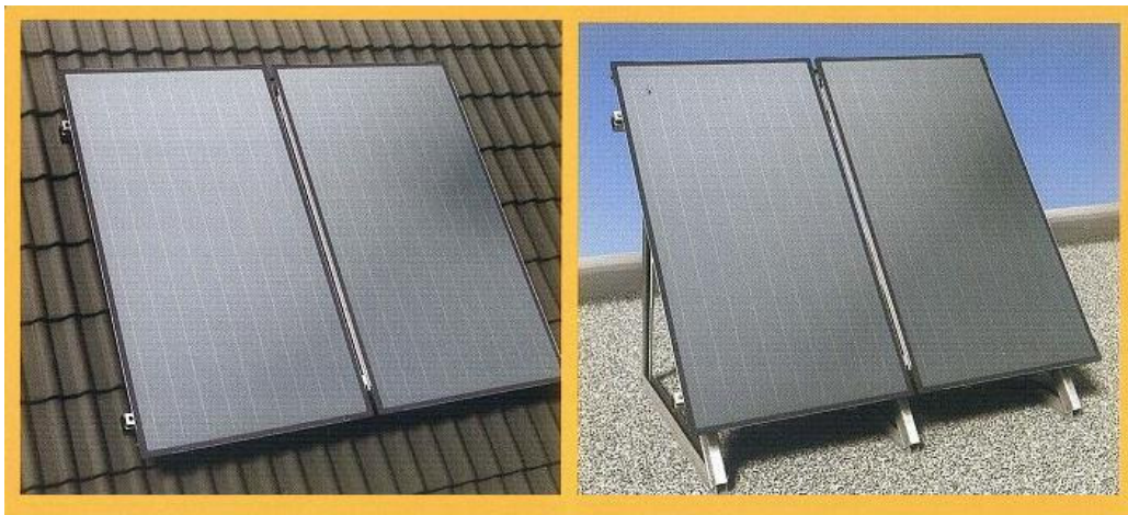
Fig. 3.18. Captatoare solare plane montate pe acoperiș (stânga) și la sol (dreapta) [*****34].
