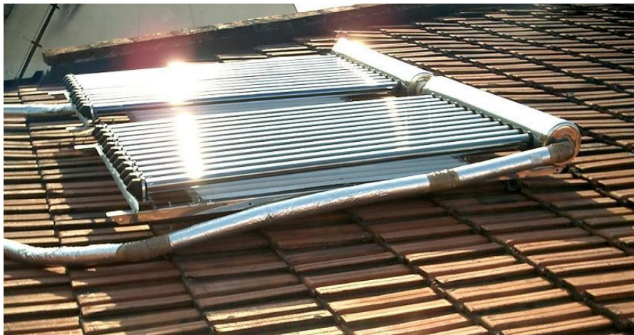
Fig. 4.9. Panouri solare montate pe acoperiș (faza finală)
