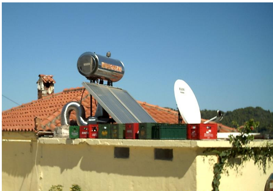
Fig. 3.6. Sistem solar termosifon (foto Grecia)
