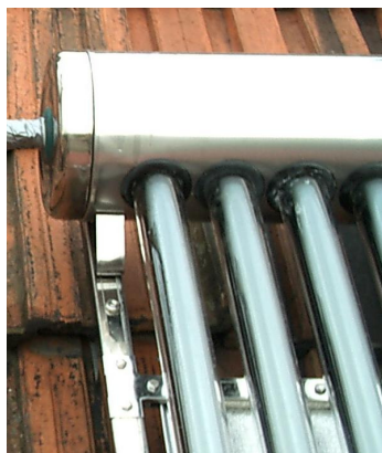
Fig. 4.15. Condensator-colector cu tuburi vidate montate.
