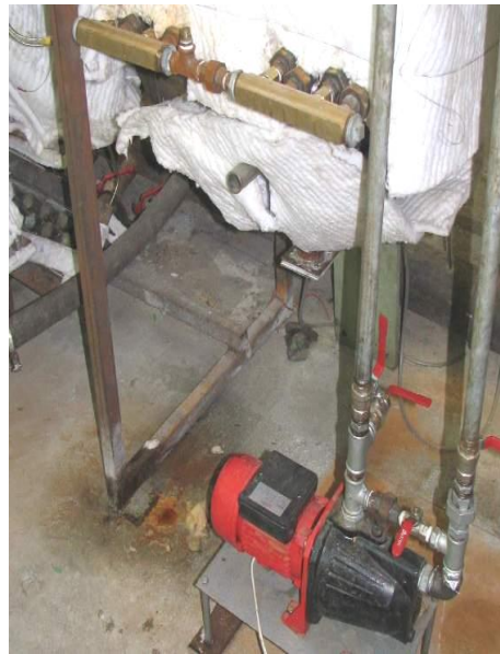
Fig. 4.18 Pompa de apă
