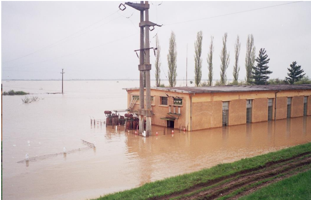
Stația de pompare Cruceni – mal drept Râul Timiș
