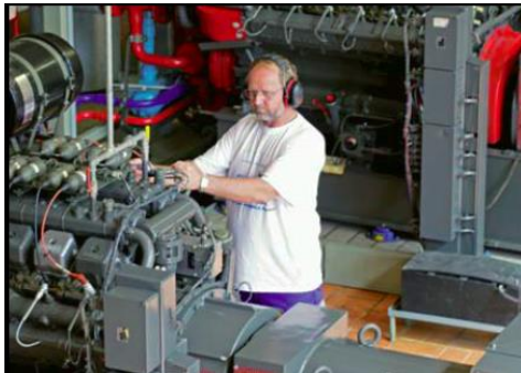
Fig. 4.1.3 Imagine din hala generatoarelor
