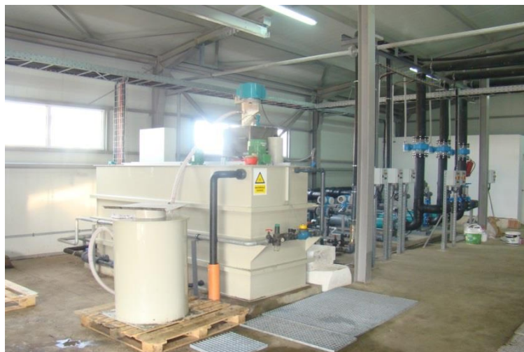
Fig. 4.2.8 - Instalația de dozare a polimerului SE Timișoara
