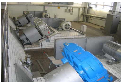
Fig. 4.3.15 – Stația de pompare
