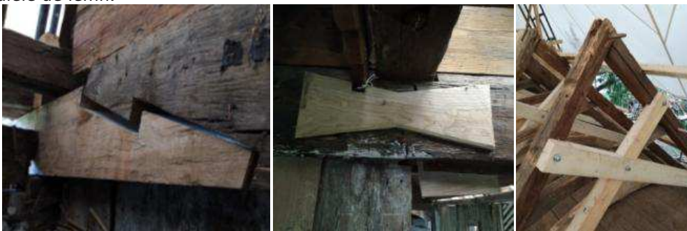
Fig. 60 –Element continuizat realizat în tehnica celui secționat / Element de plombare detașat față de elementul în care este introdus / Elemente noi de contravântuire montate cu elemente contemporane de prindere. Foto echipa Biserici Înlemnite 2019
