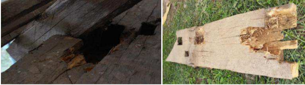
Fig. 55 –Detaliu zona degradată a cosoroabei/ element secționat în timpul șantierului cu secțiunea activă nesemnificativă. Foto Echipa Biserici Înlemnite
