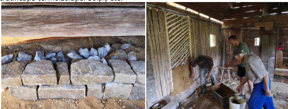
Fig. 84 –Modul de realizare a fundațiilor, cu stratul ventilat în interior / Realizarea probelor de tencuială de pământ pe suportul de nuiete de alun. Foto echipa Biserici Înlemnite
