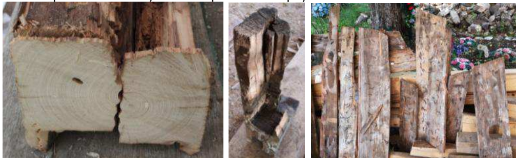
Fig. 64 – Parte din elementele înlocuite, care vor fi păstrate în biserică: Element de calitate remarcabilă, secționat din piciorul degradat turnului / Capătul rupt al grinzii (corzii) transversale a iconostasului care a pricinuit mari probleme structurale / Scânduri din fosta pictură a bisericii, folosite în perioada interbelică pe post de astereală a coifului turnului. Foto echipa Biserici Înlemnite 2019
