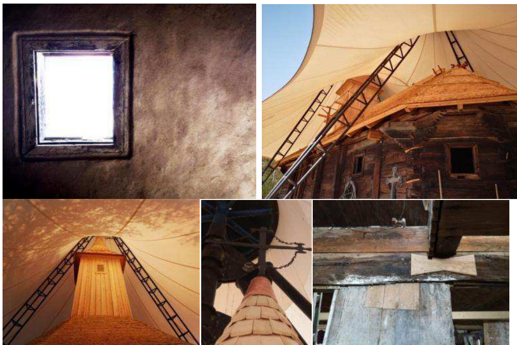
Fig. 86 Tencuiala se oprește într-un nut în jurul tâmplăriei. / Detaliul de streășină / Montarea „în evantai” a scândurilor pe tamburul, trunchi de piramidă, al turnului. / Detaliul de vârf al turnului și racordul dintre crucea și draniță / Detalii de plombare văzute dinspre altar. Foto echipa Biserici Înlemnite 2019
