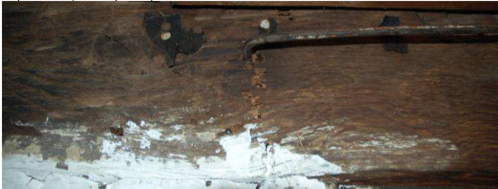
fisură în grinda de stejar transversală superioară de pe axul 7
