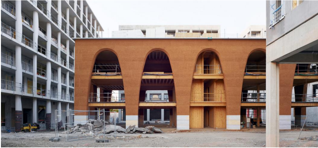
Fig. 239. Pavilionul Orangeriei în timpul construcției, sursă: © F.Fouillet, preluat din articolul "L'Orangerie – A new generation of earth building in Lyon" de Stefan Jeske, Clément Vergély Architects (CVA), Lyon, France, publicat în cadrul conferinței;
