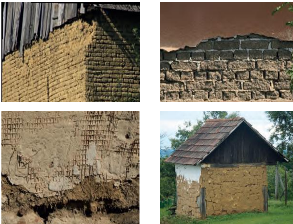
Fig. 20. Diferite tipuri de pereți – văiuță, cărămidă arsă, bulgări de pământ, pământ compactat în Slovenia, sursă : © Fernando Vegas, Camilla Mileto, Terra Europae, „Earthen Architecture in the European Union”, ISBN 978-88-467-2957-6, ultima accesare: 03.2021;
