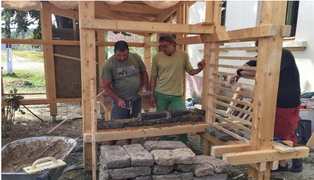
Fig. 220. Pavilion cu structură din lemn realizat în fața căminului cultural din Buzad, atelier privind utilizarea cărămizilor nearse, sursă: E.R. Florescu;
