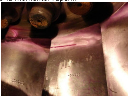
Fig. 5.11 Fisură în paleta rotorului turbinei Francis ce echepeaza HA1 de la CHE Brădișor
