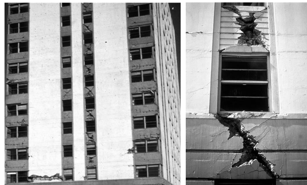
Fig. 2.2 Degradări structurale ale clădirii Mt. McKinley ca urmare a cutremurului din 1964 (5:36 PM), Anchorage, Alaska [13]-[16]
