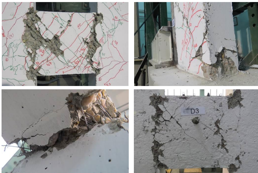
Fig. 4.22 Degradarea elementelor componente elementului CSFRCW-22-CO
