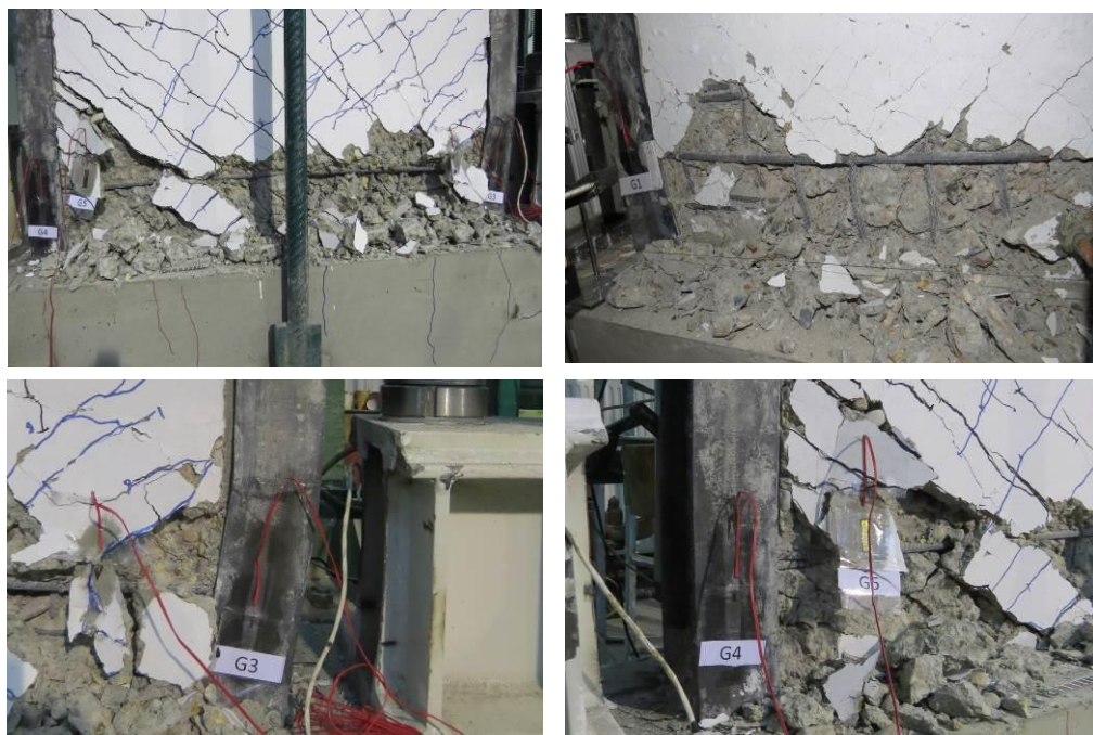
Fig. 4.26 Modul de cedare a elementului CSRCW-10
