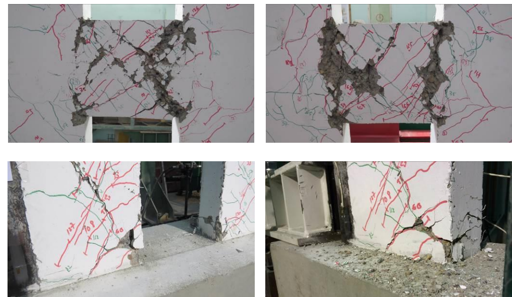
Fig. 5.21 Detalii ale degradărilor la nivelul elementelor componente a peretelui compozit CSFRCW-22-CO
