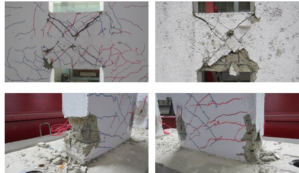
Fig. 5.22 Modul de cedare al peretelui structural RCW-23-CO
