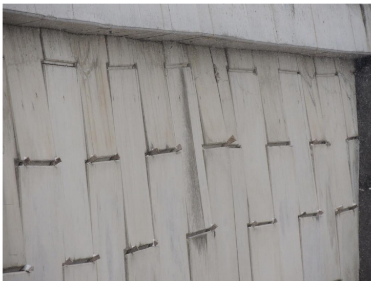
Fig. 6.71. Deplasări laterale ale panourilor de pe parament
