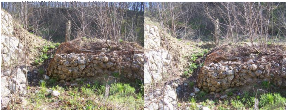
Fig. 6.8. Efectele alunecării – gabioane distruse
