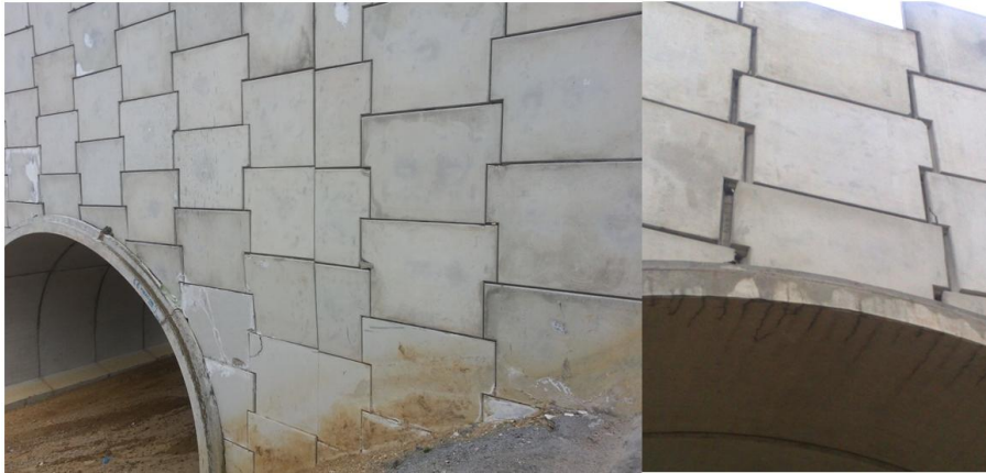
Fig. 6.98. Deplasarea în planul paramentului a panourilor cu închiderea totală a rosturilor de tasare și deplasarea panourilor în zona bolții
