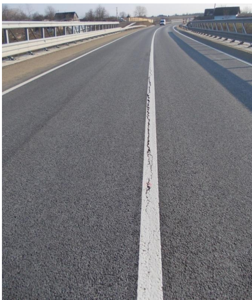
Fig. 6.75. Linia de fisură apărută în structura rutieră
