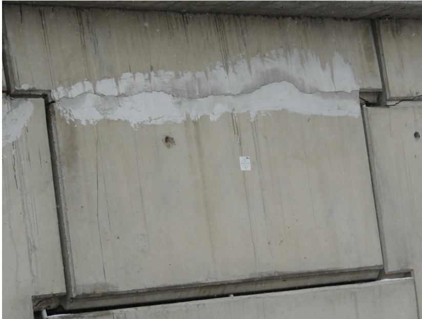
Fig. 6.72. Deplasări și fisuri ale panourilor de parament
