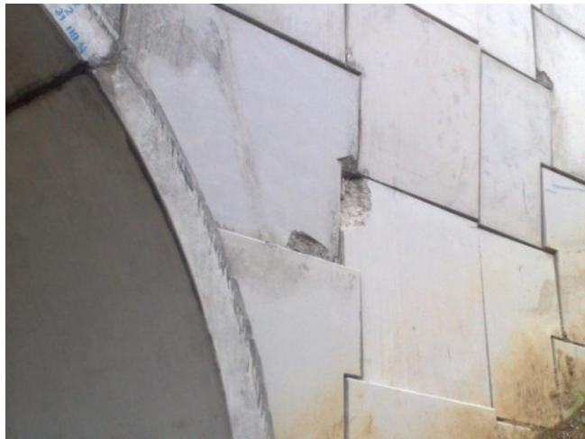
Fig. 6.99. Rotirea și strivirea plăcilor în urma deformațiilor
