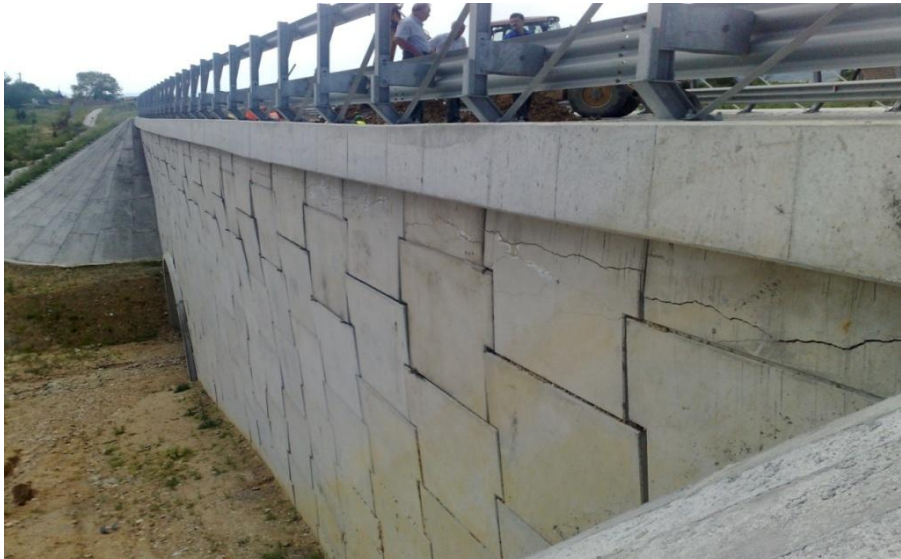
Fig. 6.73. Fisurarea panourilor superioare ale paramentului
