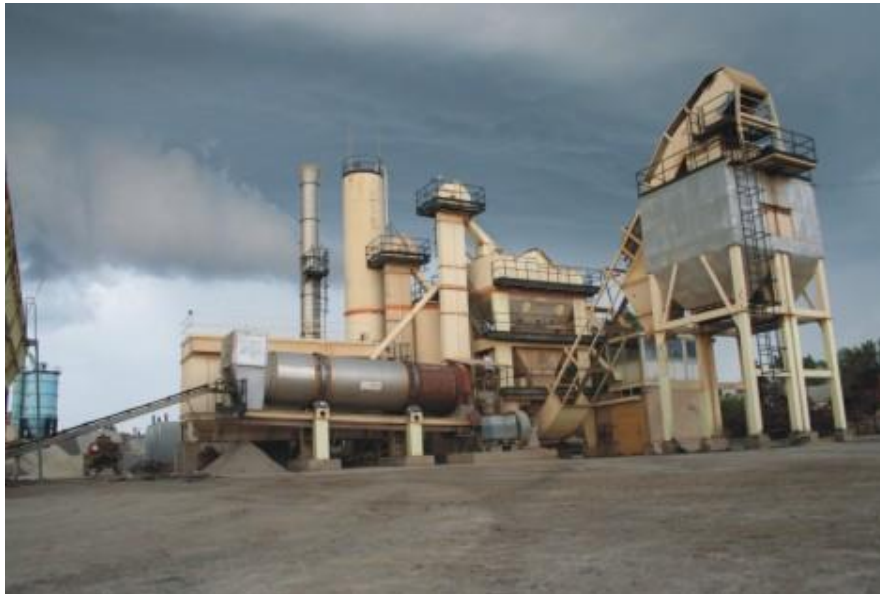
Fig. 4.15. Stația pentru prepararea mixturilor asfaltice
