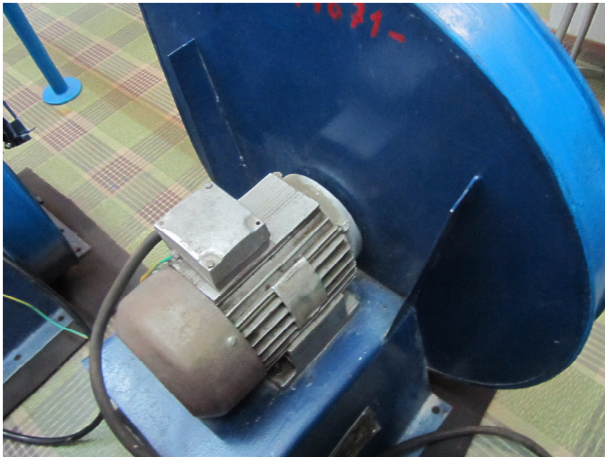
Fig.3.4 Motor electric pentru vehicularea aerului
