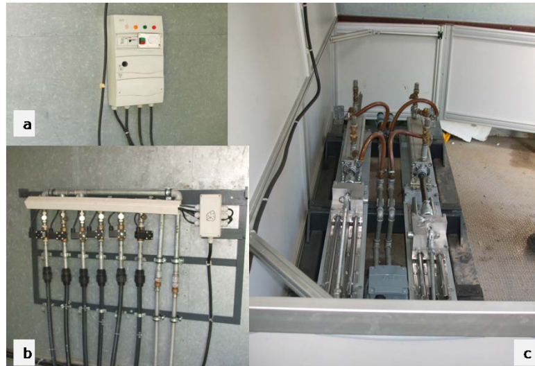
Fig. 3.9 Instalația de aerare cu: a - Panoul de control; b - Distribuția; c - Sistemul de pompare
