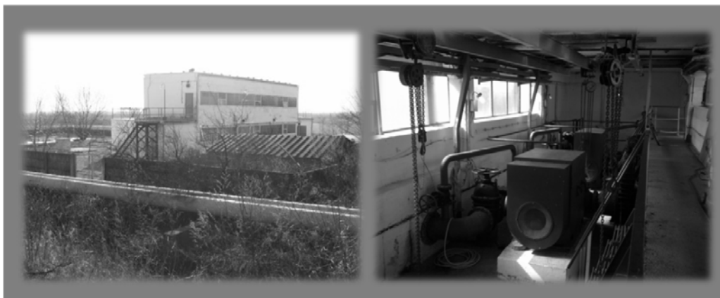
Fig. 3.47 Stația de pompare și pompele
