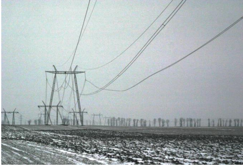
Fig. 3.1.4. Galoparea conductoarelor LEA de 400 kV datorită vântului puternic
