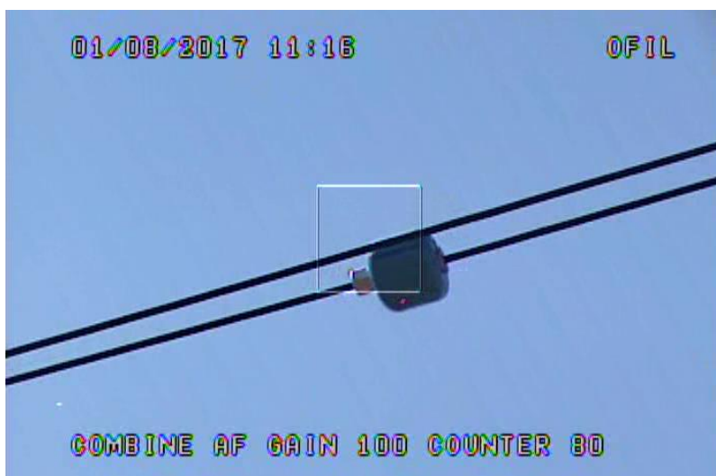
Fig. 6.6.9. Modulul NOVA OHLM - HV fără descărcări corona la tensiunea de funcționare a LEA 400 kV București Sud - Pelicanu
