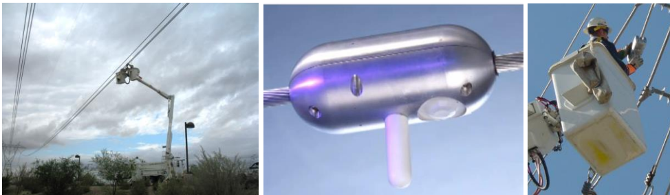
Fig. 5.1.5. Sistemul de monitorizare a liniilor electrice aeriene tip TLSM, Idaho Laboratory
