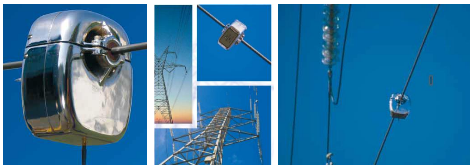
Fig. 5.1.6. Sistemul de monitorizare a liniilor electrice aeriene tip SMT Arteche
