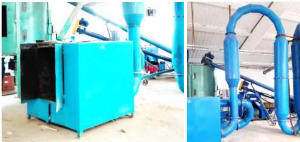
Figura 2.4 Instalația de uscare
