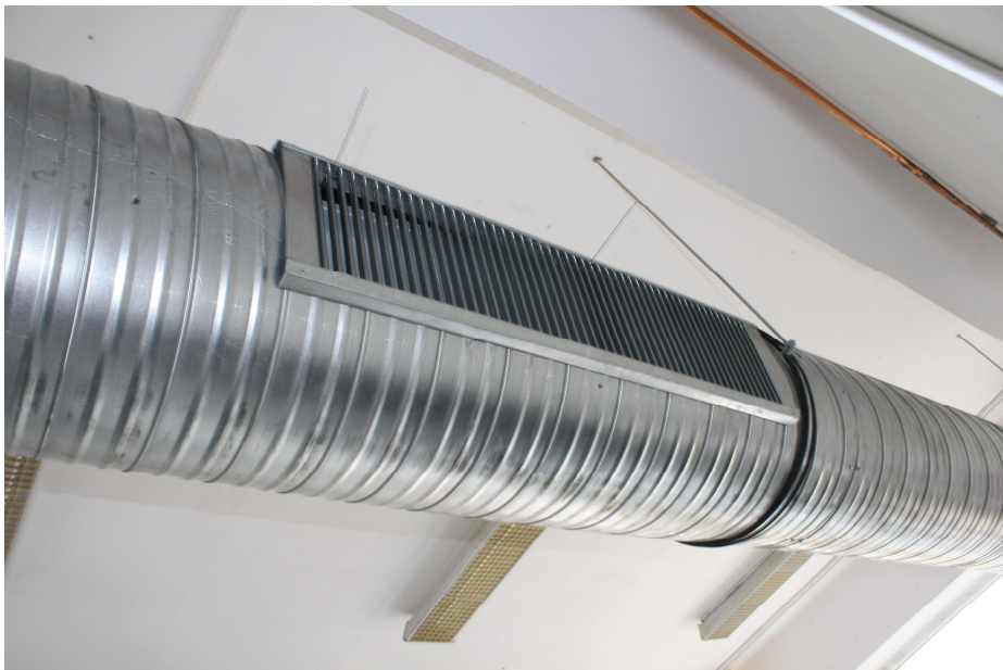
Poză B10 – Tubulatură de aspirație cu grila de evacuare
