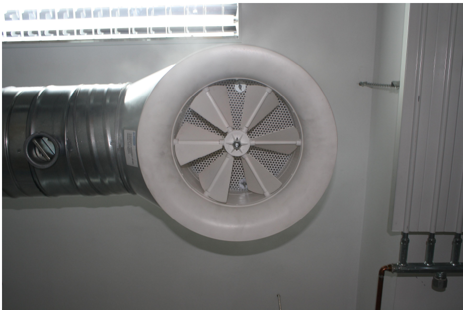
Poză B12 – Gura de introducere cu vârtej vedere de jos
