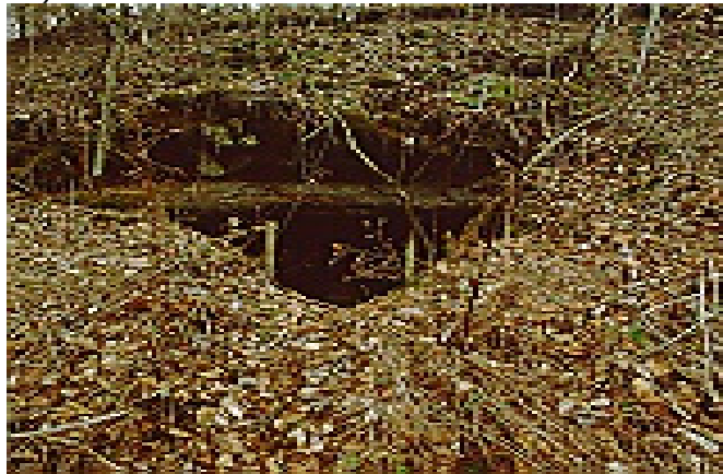
Figura 3.5 Prăbușirea tavanului unei galerii [www.osmre.gov]
