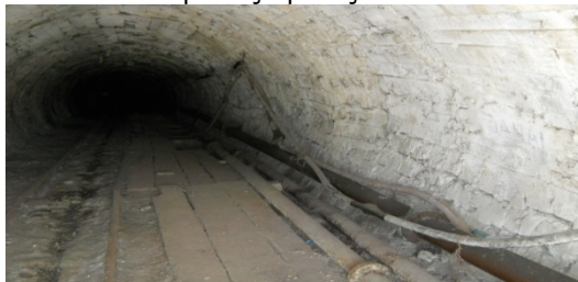
Figura 4.21 Evacuare ape de mina prin teava metalica [Riti A., 2011]
