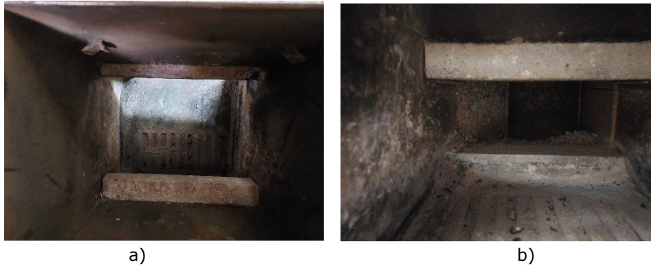
Fig. 4.19. Focarul și primul drum al gazelor de ardere: a) vedere de sus, b) vedere din față, [arhiva proprie]
