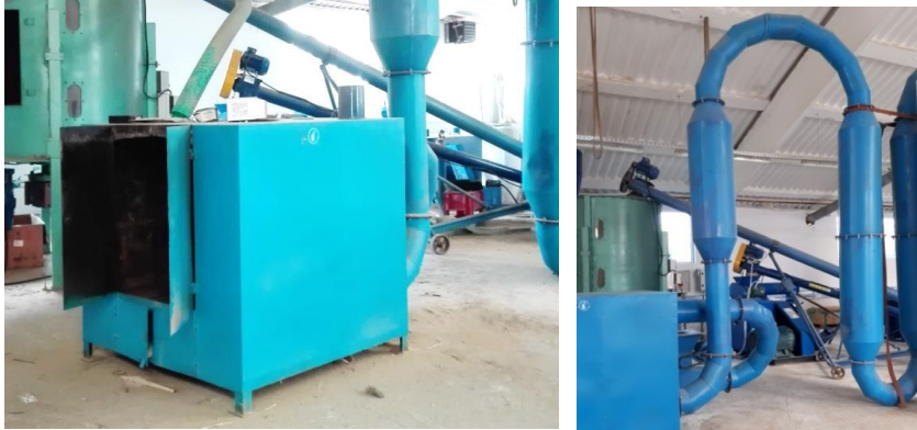
Fig. 3.9. Instalația de uscare (cuptorul de ardere împreună cu tubulatură în care are loc uscarea uscare), [arhiva proprie]
