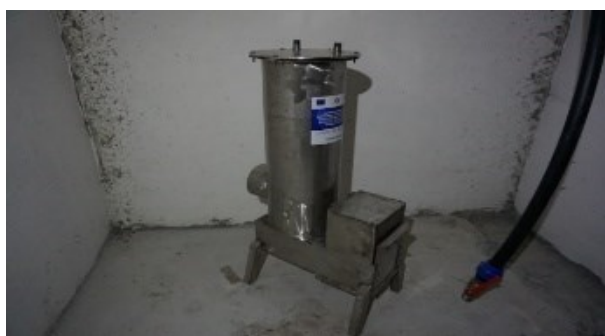
Fig. 4.16. Centrala termică pilot, [arhiva proprie]
