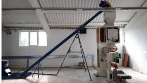
Fig. 3.16. Transportor elicoidal și instalație de ambalare, [arhiva proprie]
