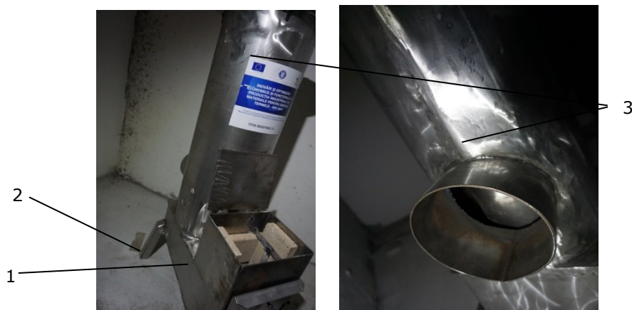
Fig. 4.17. Centrala termică pilot: 1-tub de alimentare, 2-focar, 3-corpul centralei, [arhiva proprie]
