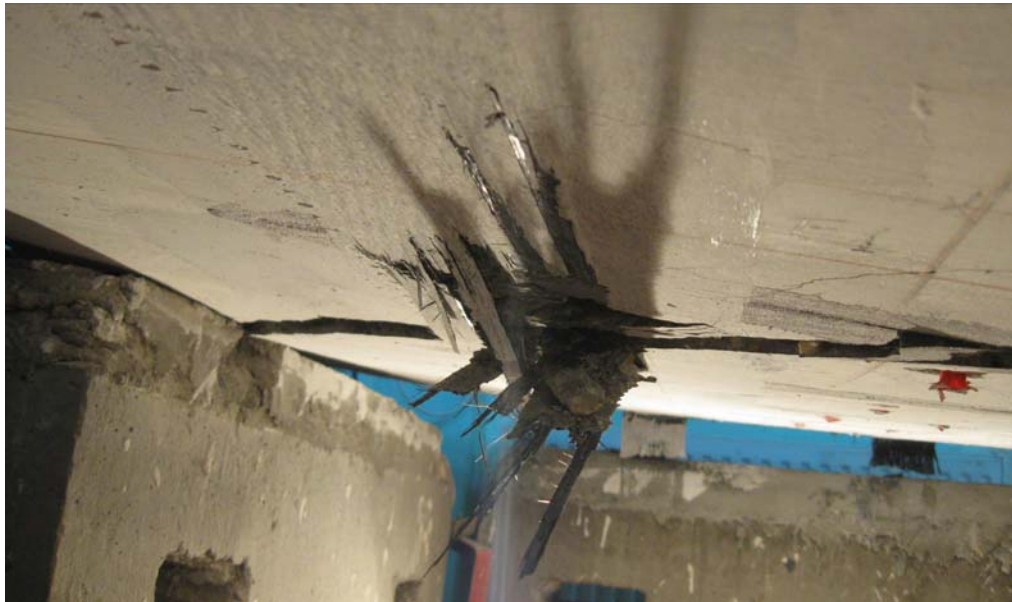
Fig. 6.84. - Detaliu de cedare țesătură intersectată de fisură principală
