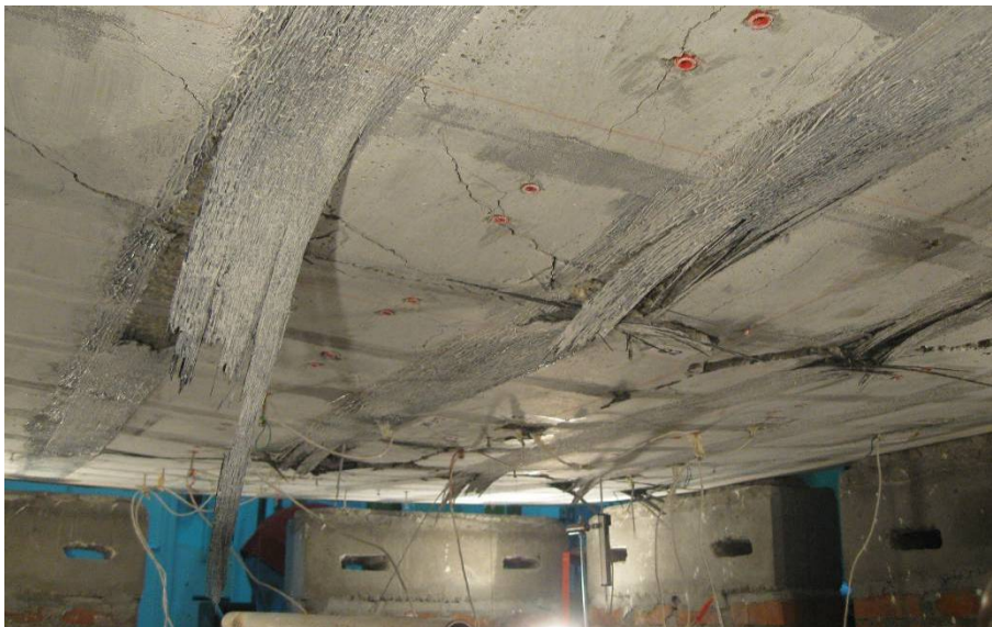
Fig. 6.40. - Vedere de ansamblu a feței inferioare a elementului după cedare
