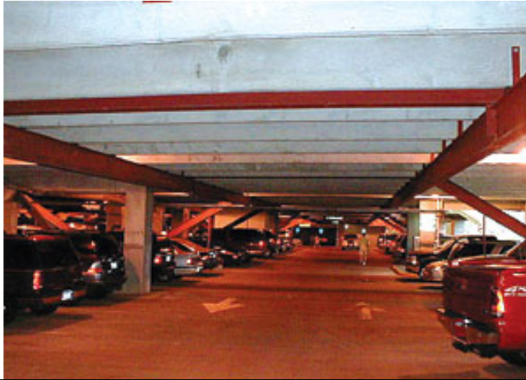
Fig. 2.17. - Instalarea unui ansamblu structural metalic pentru scurtarea deschiderilor unui planșeu într-un garaj (cf. [045])
