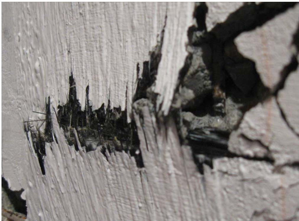
Fig. 6.85. - Detaliu de cedare bandă și țesătură intersectate de fisură principală
