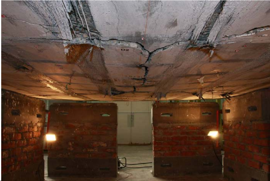
Fig. 6.39. - Vedere de ansamblu a feței inferioare a elementului după cedare
