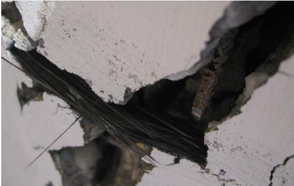
Fig. 6.87. - Detaliu de cedare armătură și bandă intersectate de fisură principală
