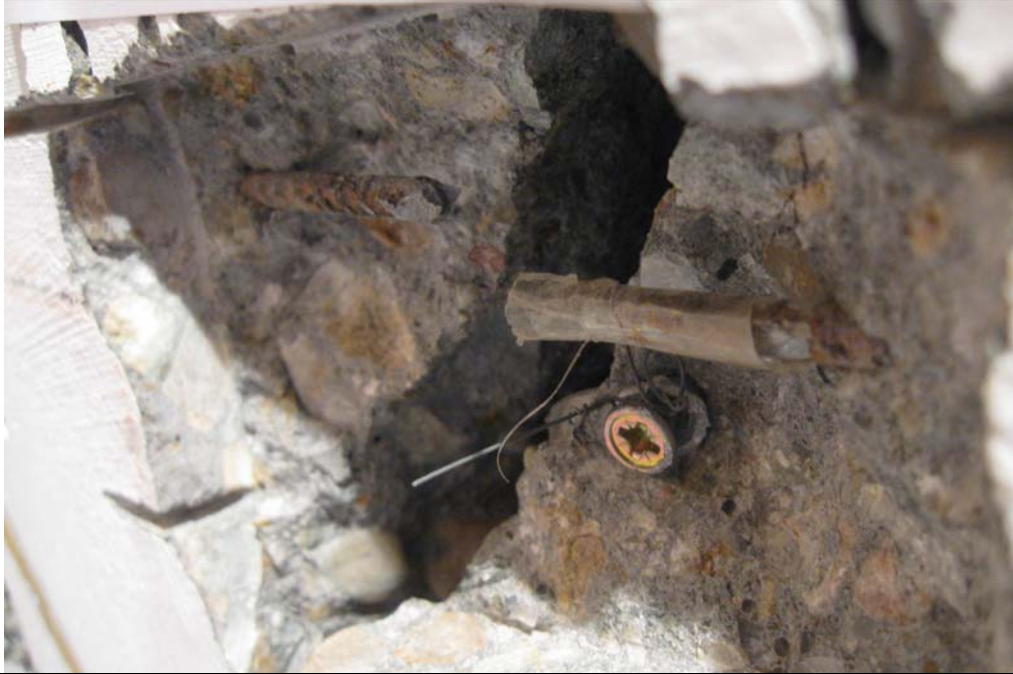
Fig. 6.86. - Detaliu de cedare armătură intersectate de fisură principală
