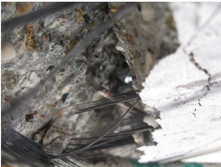
Fig. 6.72. - Vedere a fisurii principale în zona captorului D7 (armătură și elemente CFRP rupte)
