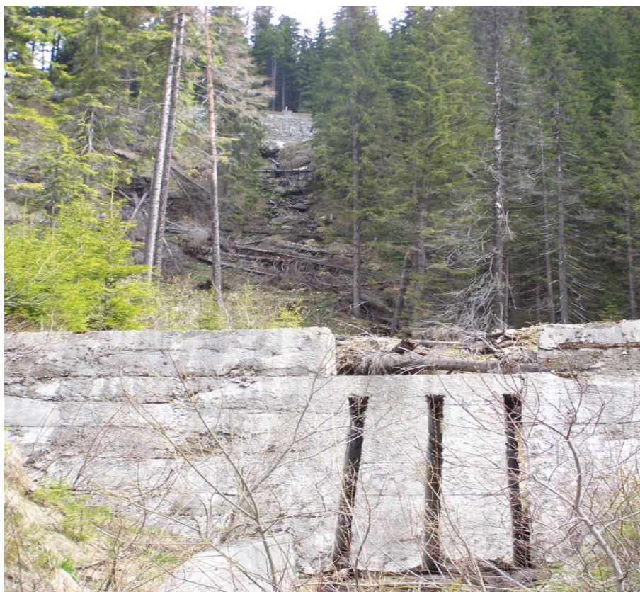
Fig. 1.3. Baraj de corectarea torenților neîntreținut
