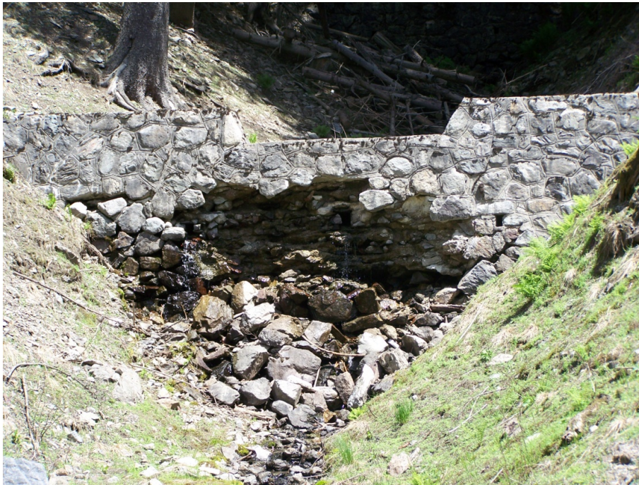
Fig. 1.2. Sistem de corectarea torenților distrus parțial datorită subdimensionării
