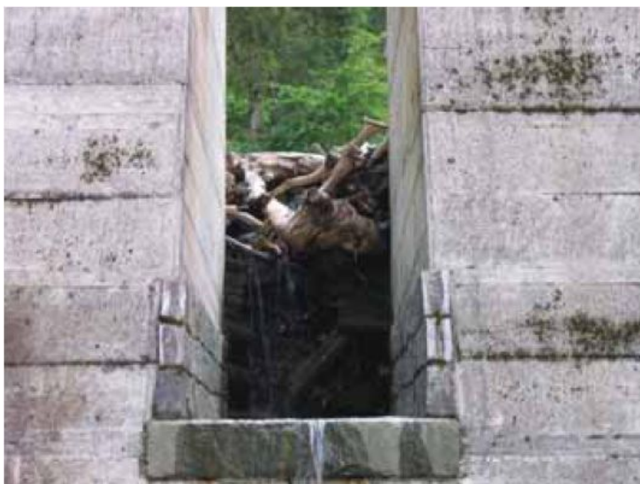
Fig. 2.4. Aluviuni cu material lemnos în sistemul de corectarea torenților
