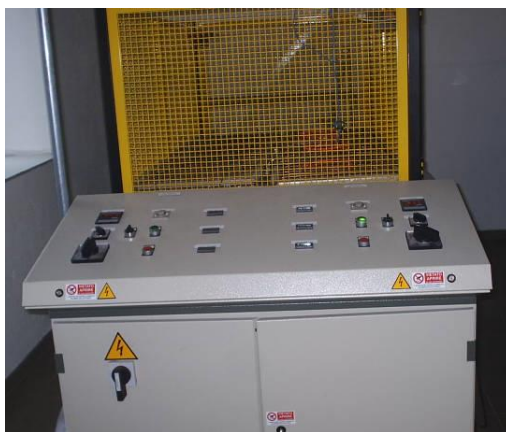
Figura 6.9. Banc automatizat pentru testul de anduranță termică
