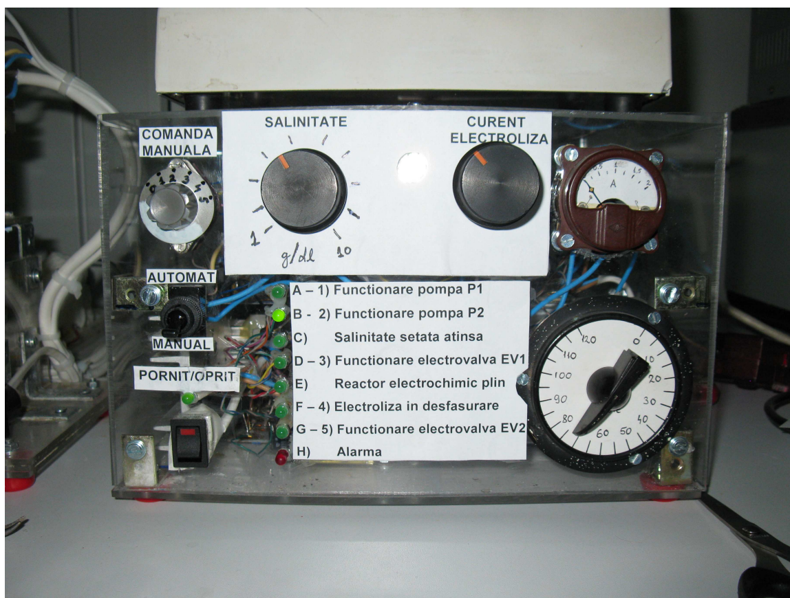
Figura 31. Sistemul de automatizare. Vedere frontală.
