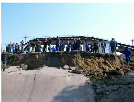
Foto nr. 1.4 Alunecare în zona B.T.Cărbune, Seciuri – 2005
