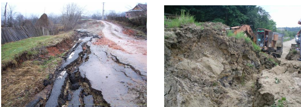
Foto nr.4.2 Degradări la DJ 675C
