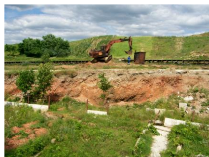
Foto nr.1.10 Alunecare de maluri în satul Seciuri -Roșia de Amaradia / 2006
