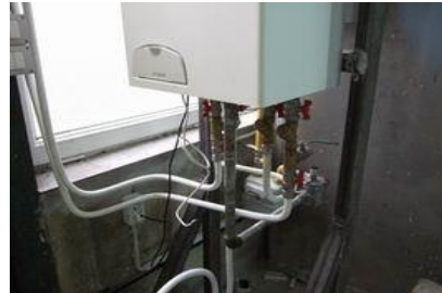
Figura 4.14. – Cazanul folosit pentru încălzirea instalației [11]
