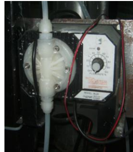
Figura 4.21. – Pompă dozatoare folosită pentru spălarea biogazului [99]
