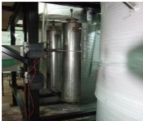
Figura 4.19. - Filtrul de H_2S (în partea din spate) și filtrul de CO_2 (în partea din față) a instalației. [11]
