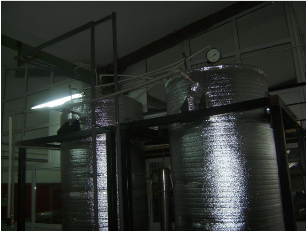
Figura 4.12. – Rezervoarele de fermentație anaerobă [11] [13] [37]
