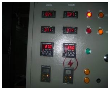
Figura 4.15. – Panoul de comandă și monitorizare al instalației
