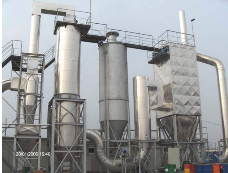
Figura 33 Instalația tehnologică de epurare a gazelor arse
