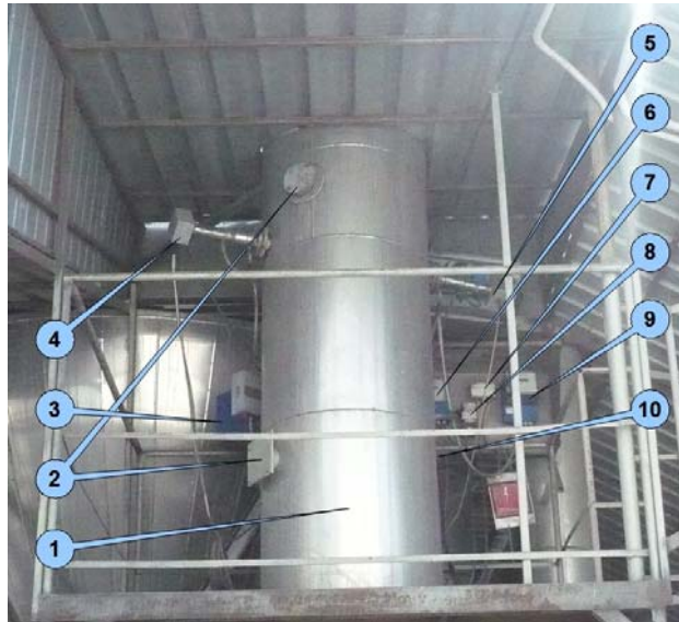
Figura 39 Sistemul de prelevare și analiză a gazelor montat pe coș: 1 – coș, 2 – flanșe pentru introducerea unor sonde suplimentare, 3 – sondă prelevare gaze, 4 – emițător laser NEO Laser-Gas monitor, 5 – detector NEO Laser-Gas monitor, 6 – transmițător DURAG, 7 – convertor umiditate, 8 – traductor de presiune diferențială, 9 – unitate de evaluare și control DURAG, 10 – sondă DURAG
