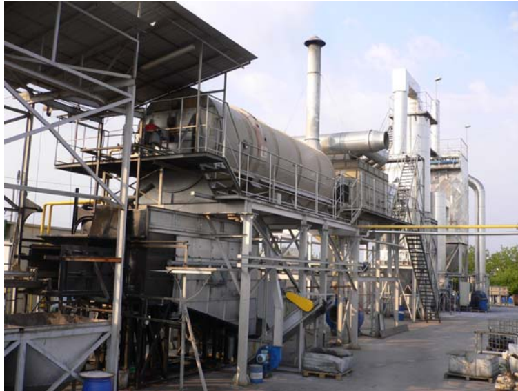
Figura 28 Vedere de ansamblu a instalației de incinerare a deșeurilor.
