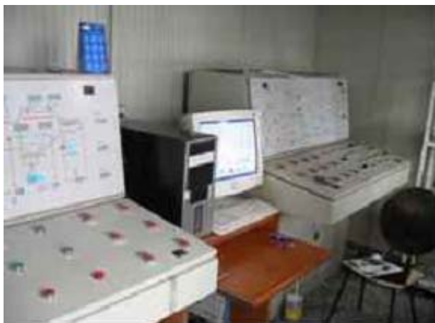
Figura 40 Vedere de ansamblu a camerei de comandă și control.
