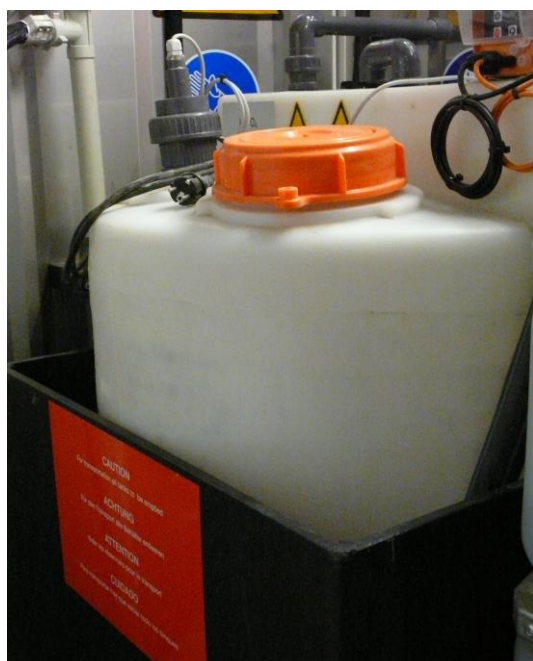
Figura nr. 5.9.1.-6. Bazin stocare acid sulfuric -B0111-
