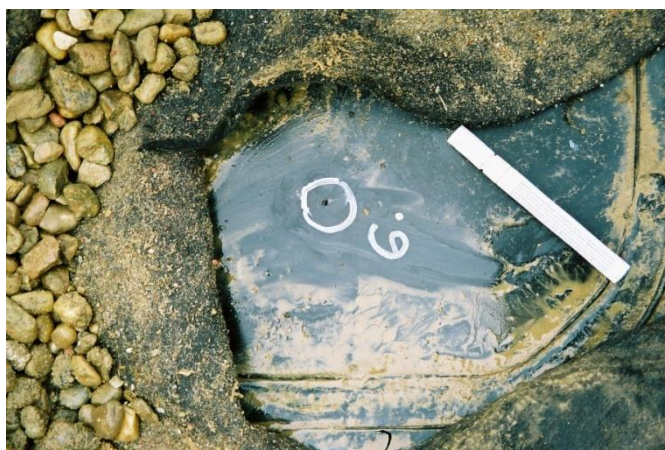
Figura nr. 3.4.5.6. -3. Spărtură în folia de izolare HDPE a radierului depozitului, identificată cu ajutorul sistemului de monitorizare geoelectric
