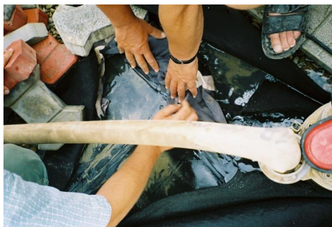
Figura nr. 3.4.5.6. -4. Spărtură în folia de izolare HDPE a radierului bazinului de colectare levigat, identificată cu ajutorul sistemului de monitorizare geoelectric
