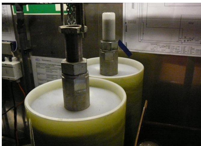
Figura nr. 5.9.5.-1. Treapta a 2-a - cu cele două module cu membrane de osmoza inversă
