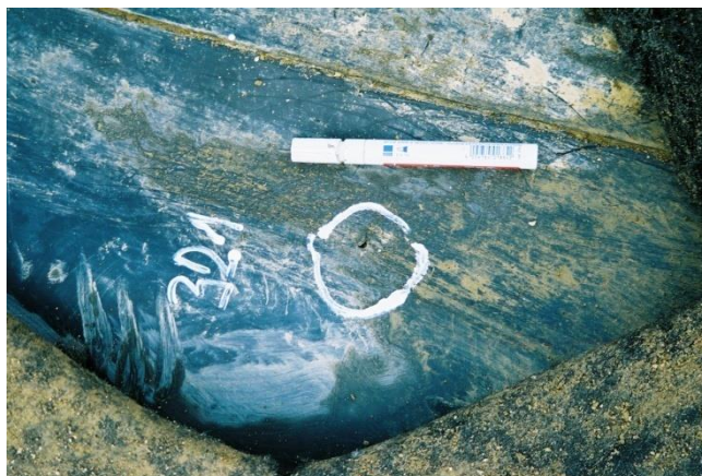
Figura nr. 3.4.5.6. -2. Spărtură în folia de izolare HDPE a radierului depozitului, identificată cu ajutorul sistemului de monitorizare geoelectric
