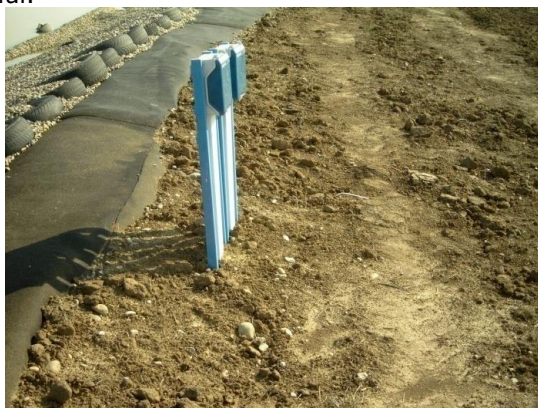
Figura nr. 3.4.5.6. -1. Panoul de comandă al sistemului geoelectric de monitorizare a defecțiunilor membranei HDPE.
