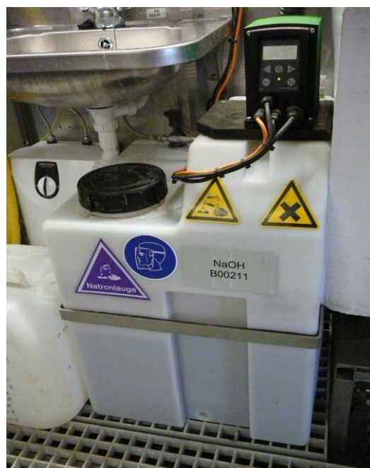
Figura nr. 5.9.1.-7. Bazin stocare sodă caustică – B00211-
