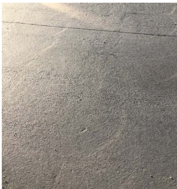
Figura 48 b. Platforma reabilitată zona fibre de oțel pe toată grosimea, respectiv pe 5 cm grosime
