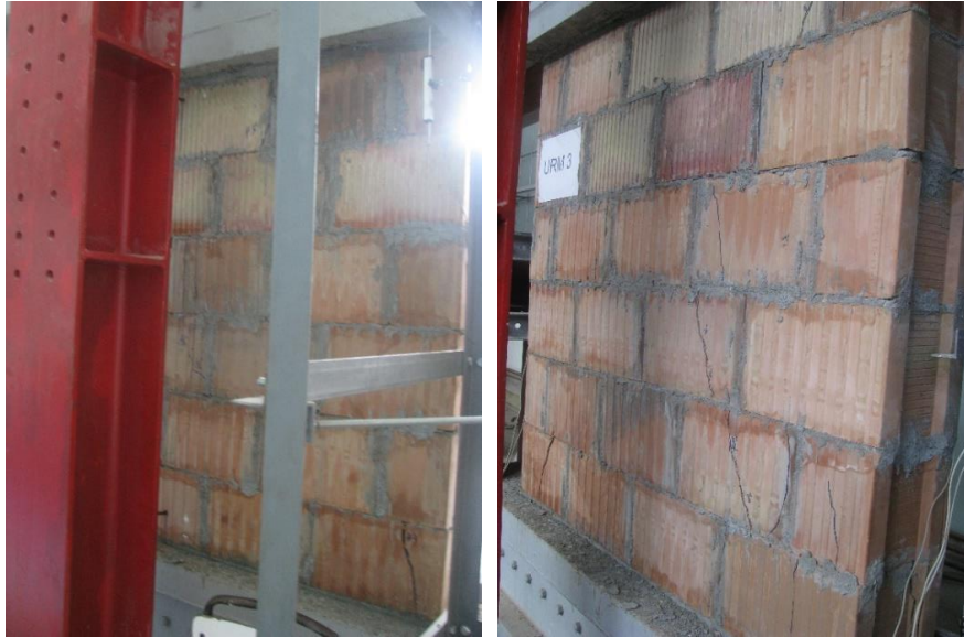
Fig. 5.5. Avarii ale elementului URM3 – zidărie nearmată
