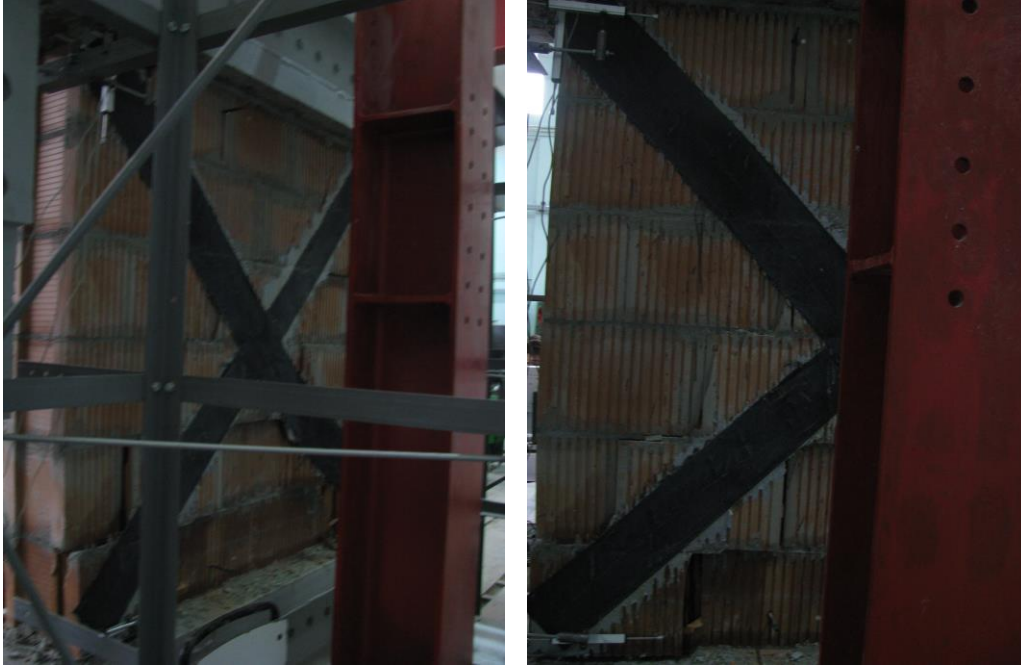
Fig. 5.32. Avarii ale elementului URM3-C – zidărie nearmată consolidată
