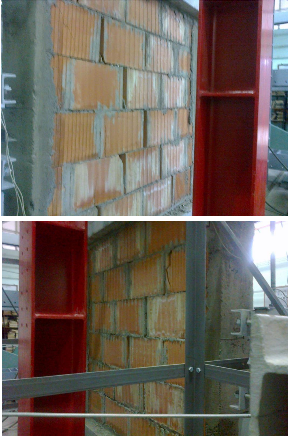
Fig. 5.12. Avarii ale elementului RM1 – zidărie confinată cu stâlpișori laterali
