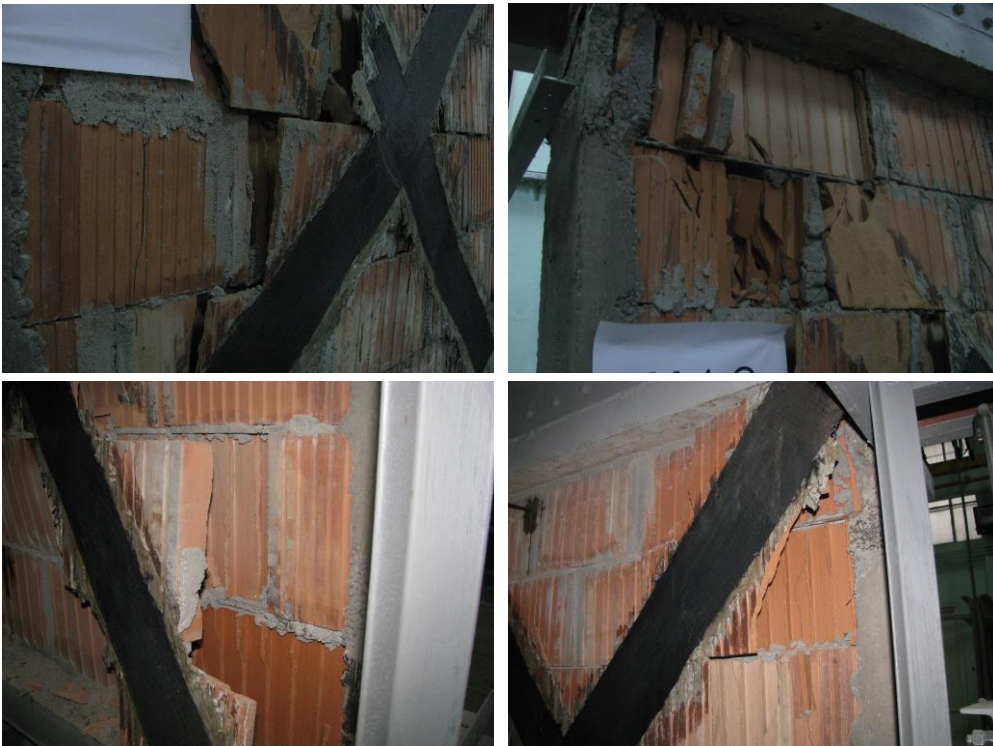
Fig. 5.41. Avarii ale elementului RM1''-C – zidărie confinată cu stâlpișori laterali consolidată
