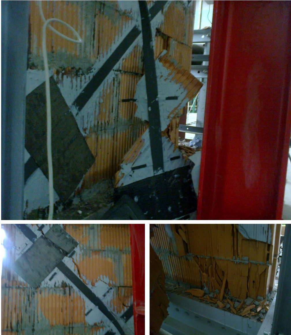
Fig. 5.30. Avarii ale elementului URM1-C – zidărie nearmată consolidată
