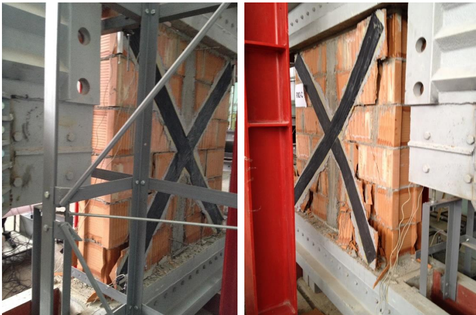
Fig. 5.50. Avarii ale elementului RM2''-C – zidărie confinată cu stâlpișor central consolidată
