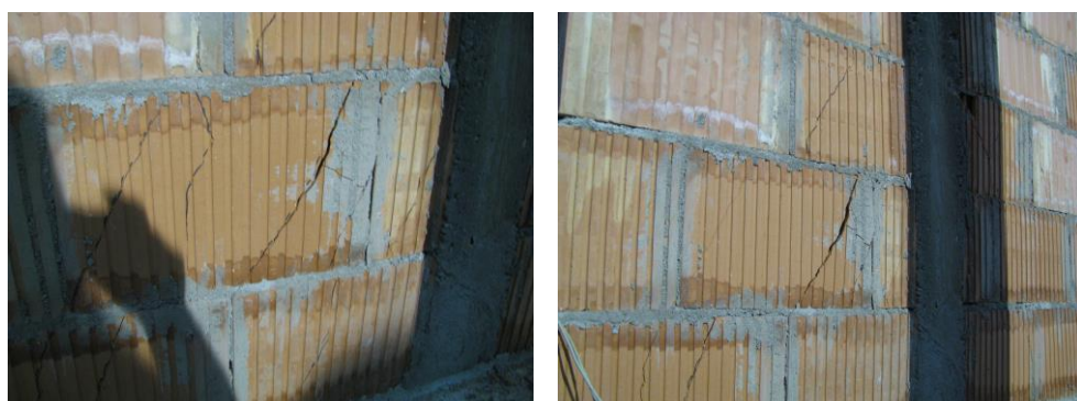
Fig. 5.23. Avarii ale elementului RM2'' – zidărie confinată cu stâlpișor central
