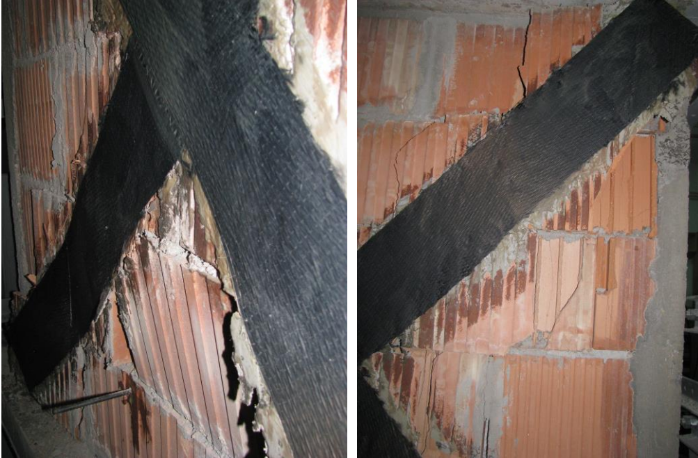
Fig. 5.40. Avarii ale elementului RM1'-C – zidărie confinată cu stâlpișori laterali consolidată
