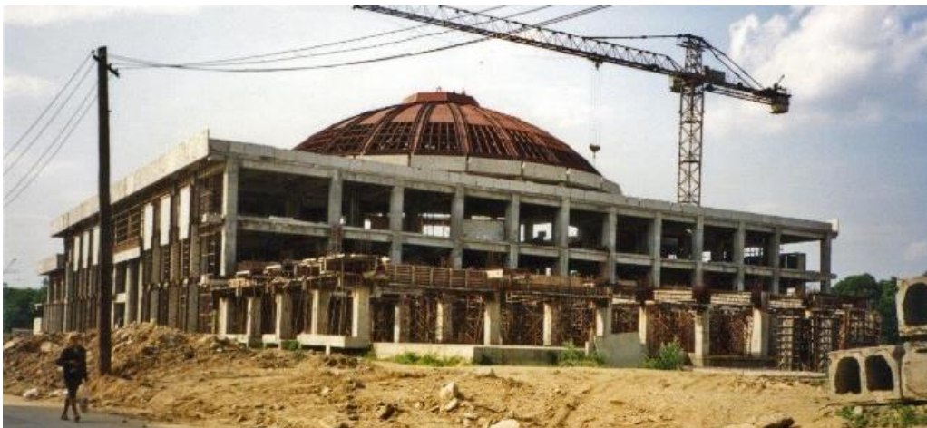
Figura 66 Complexul agroindustrial din Vitan în 1992 – structura tipică în cadre și cupola supradimensionată care a dat naștere metaforei „cercul foamei”
