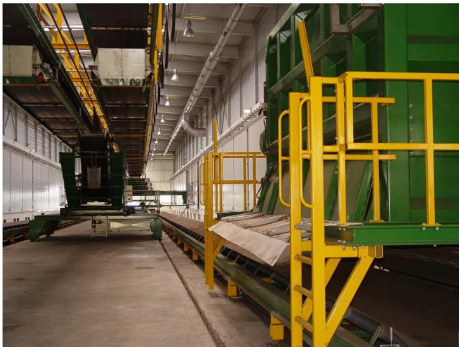
Figura 3.16 Hala cu tunelurile de compostare
