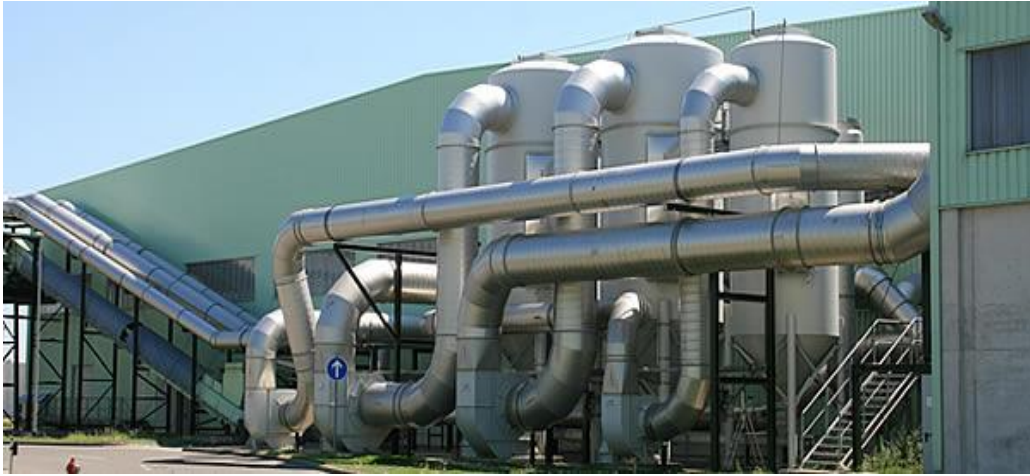
Figura 3.18 Instalația de desprăfuire
