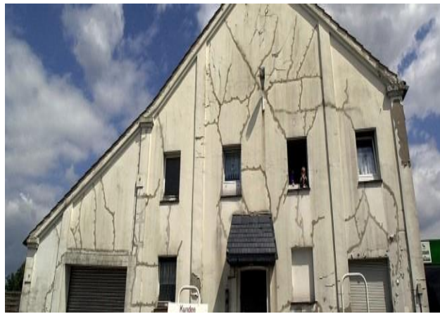
Fig. 7.9. Fisuri de fațadă [65]
