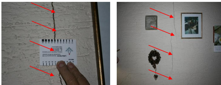
Fig. 11.2. Lățimea și zona fisurilor în peretele portant
