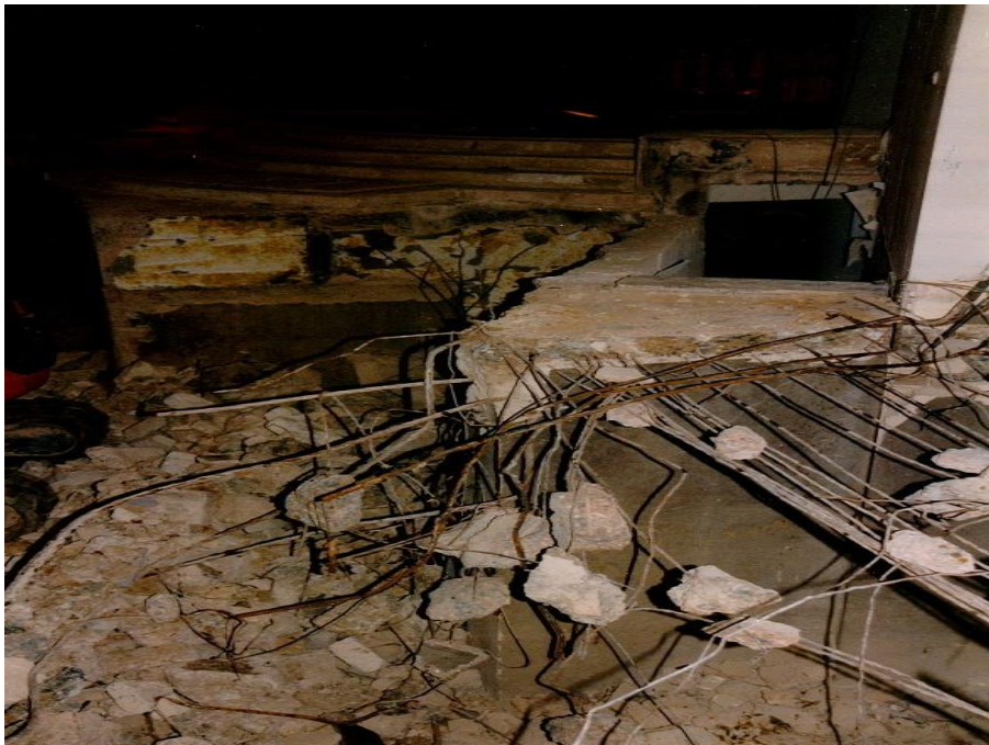
Fig. 8.4. Distrugerea plăcii de bază [8]
