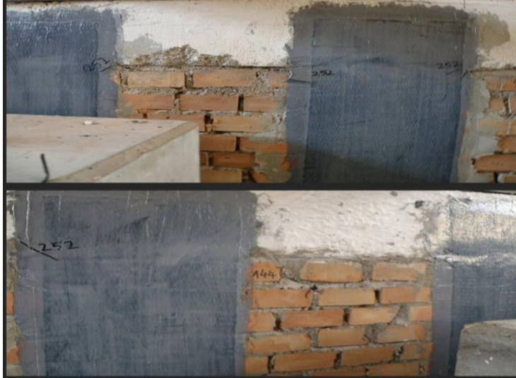
Fig. 4.47. Prezentarea cadrului cu mustăți de ancorare umplut cu cărămidă plină după apariția fisurilor
