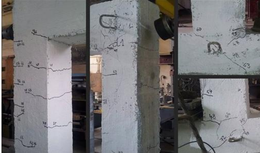
Fig. 4.28. Cadrul mator fisurat
