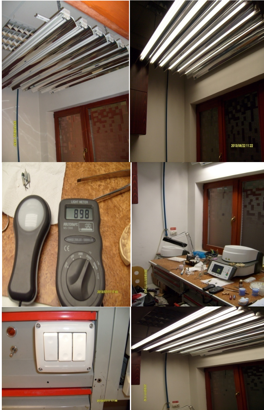
Fig.5.7. a,b,c,d,e,f. Imagini ale elementelor componente ale sistemului de iluminare din compartimentul "Camera ceramică".
