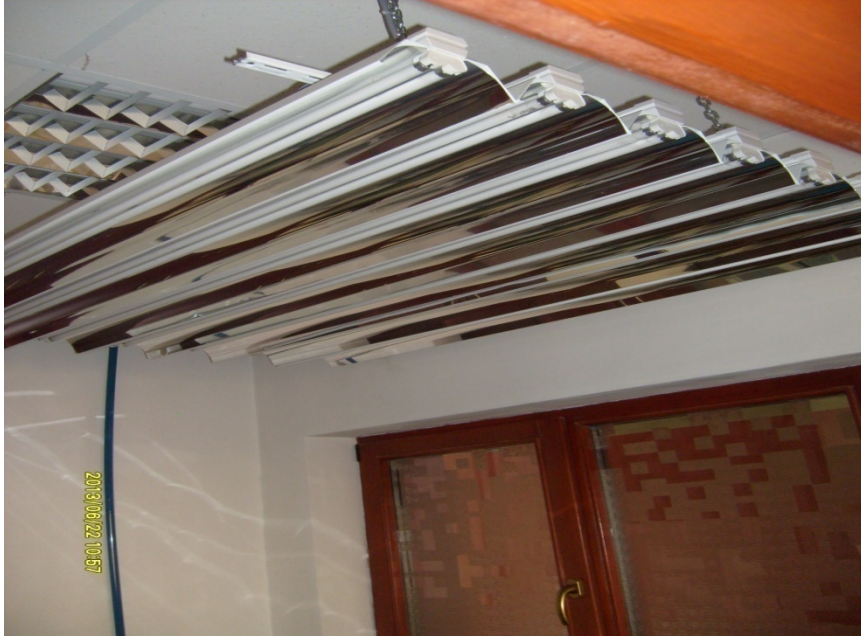
Fig. 5.17. Instalație de iluminat din laboratorul de tehnică dentară, „CAMERA CERAMICĂ”, în stare de nefuncționare.
