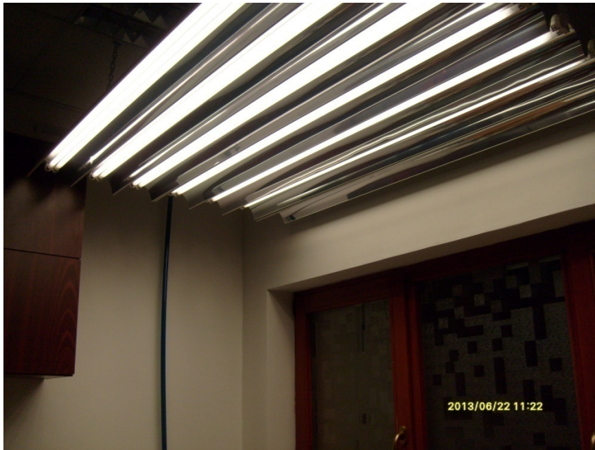
Fig. 5.18. Instalație de iluminat din laboratorul de tehnică dentară, „CAMERA CERAMICĂ”, în stare de funcționare.
