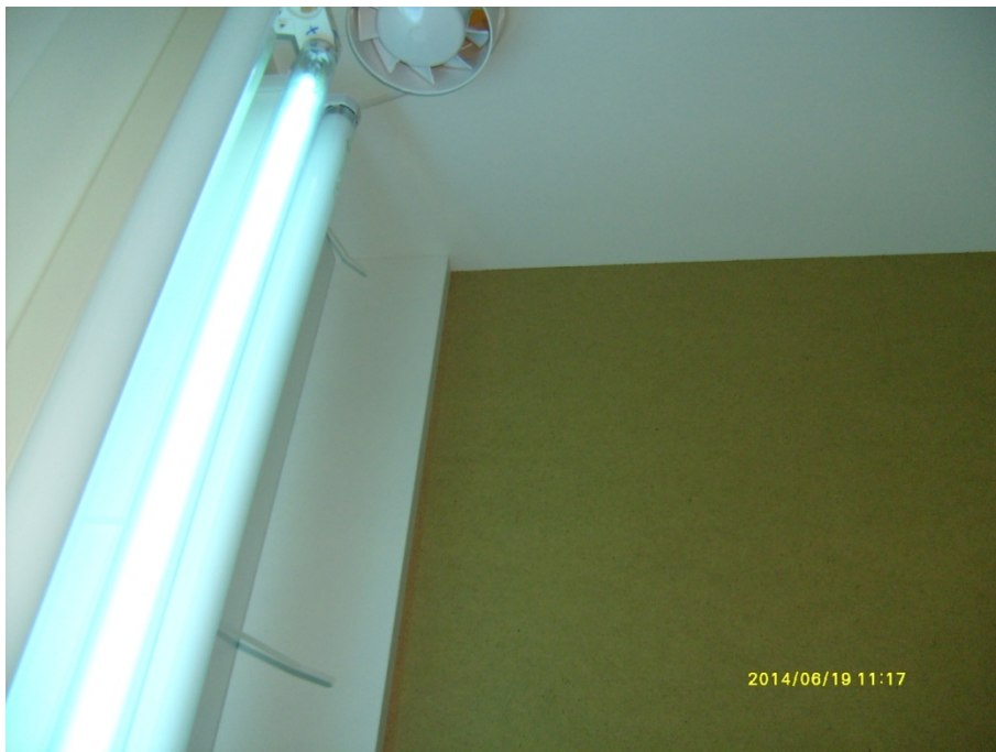
Fig. 7.32. Lampă germicidală UV-C încorporată în corpul de iluminat general fluorescent.
