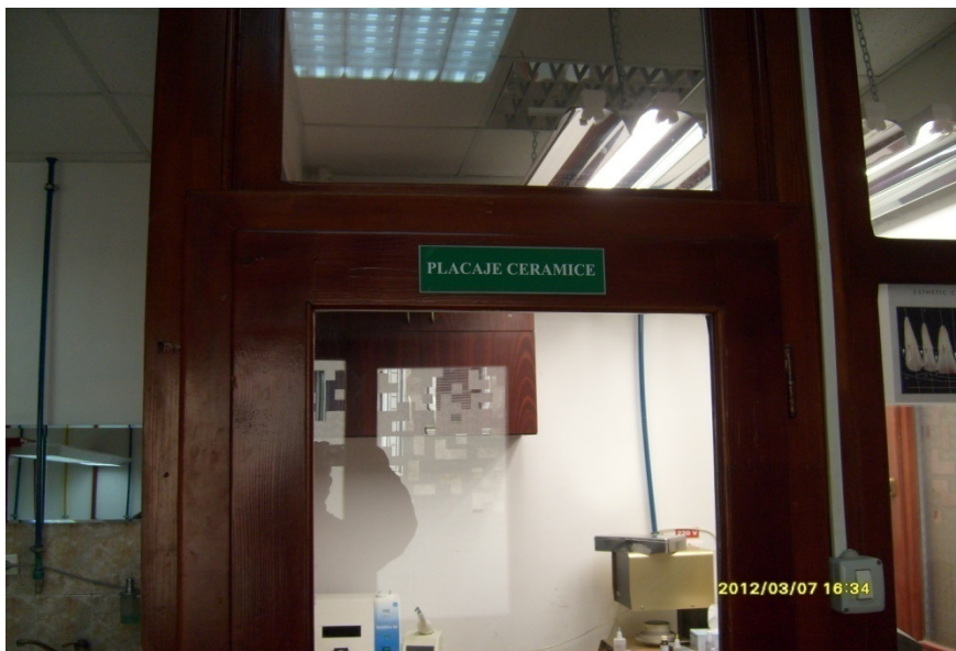
Fig. 5.10. „CAMERA CERAMICĂ” din laboratorul de tehnică dentară cu instalație electrică de iluminat. Diferența de temperatură de culoare a luminii între instalația de iluminat nouă și cea veche.
