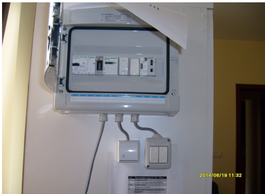
Fig. 7.5. Tabloul electric de comandă aferent instalației electrice pentru dezinfectat aerul din unitățile medical dentare, poziția B.
