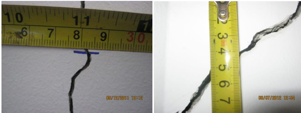
Fig. 5.8. Observarea sistematică a fisurilor și crăpăturilor din pereții clădirilor
