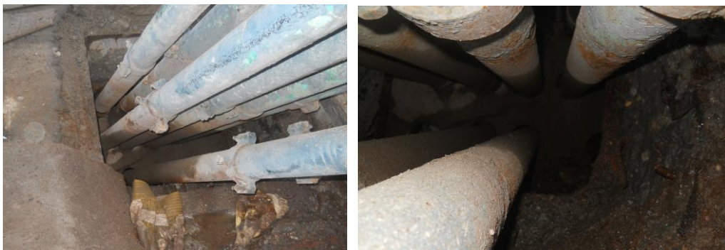
Fig. 4.10. Starea de degradare a hobanelor cauzată de fenomenul de coroziune
