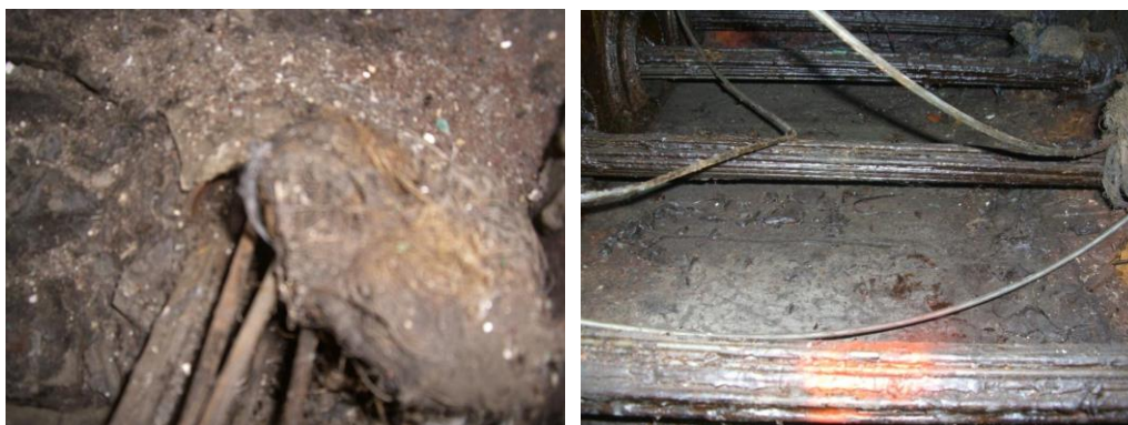
Fig. 4.9. Coroziunea și ruperea firelor din caseta de trecere [80]
