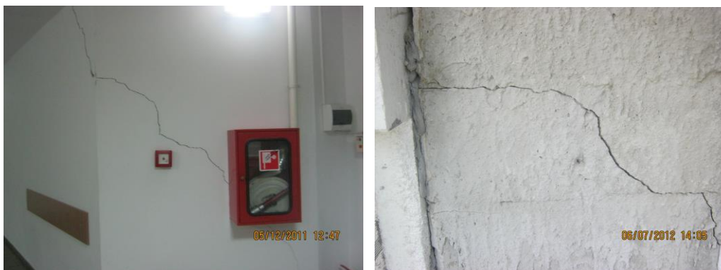
Fig. 5.7. Fisuri și crăpături apărute în pereții clădirilor
