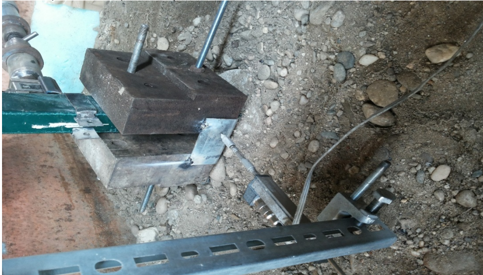
Fig. 6-24 Poziționare senzor de măsurare a deplasărilor
