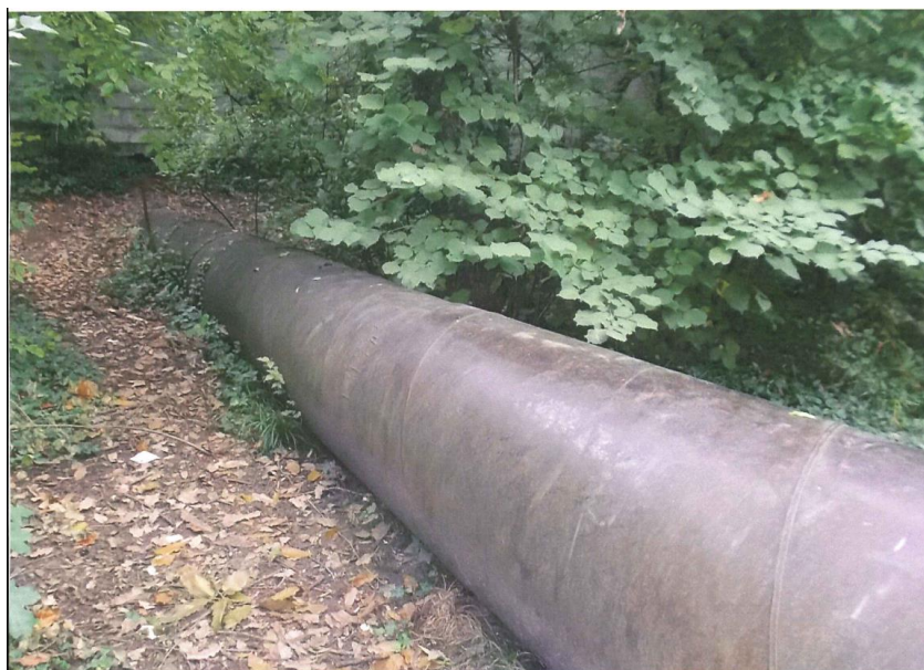
Fig. 4.22 Conductă evacuare apă meteoică
