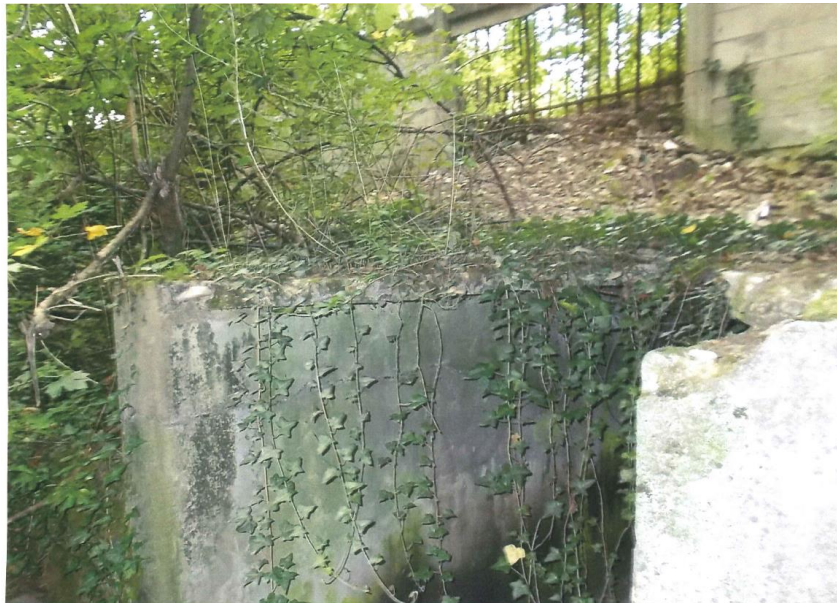
Fig. 4.20 Cămin colector stație de pompare ape meteorice
