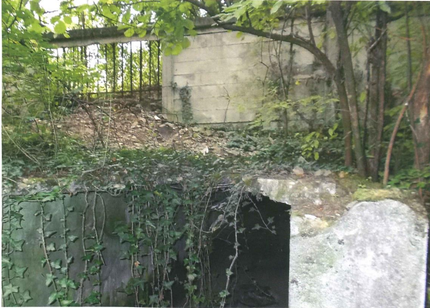
Fig. 4.19 Stația de pompare ape meteorice existentă
