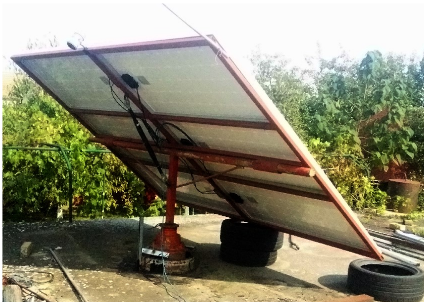
Fig. 5.4 - Structura metalică de susținere și rotație a ariei de panouri
