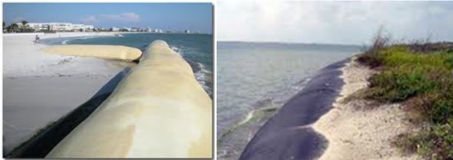
Fig. 2.33. Exemplu de apărare de mal cu geotuburi
