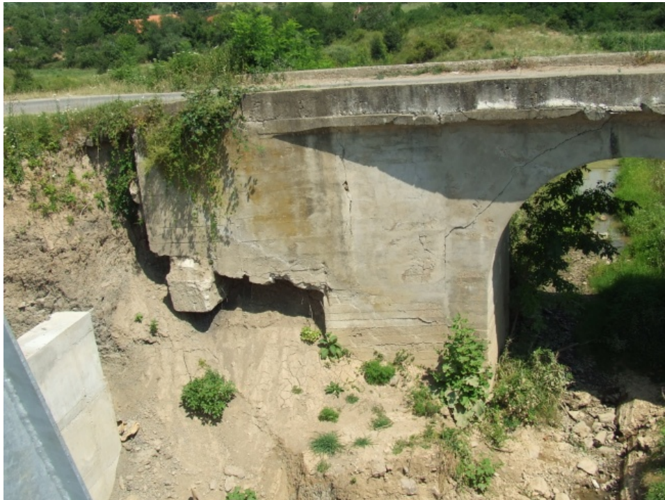
Fig. 5.2. Degradări ale podului existent
