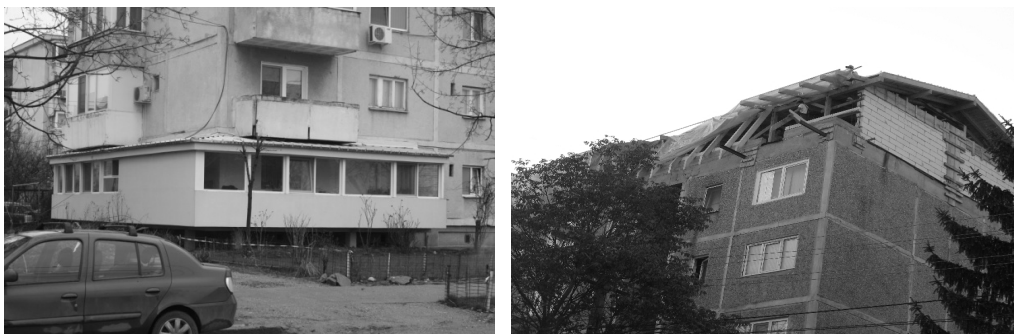
Fig.5.5. Intervenții ulterioare - exemple: extinderea abuzivă a spațiilor de la parter, mansardări neunitare, improvizate
